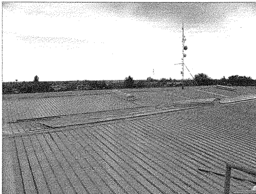
Unità affittate - PN, via Roveredo 52/B: lastrico solare - sub.6 e parte del sub.7 ed impianto fotovoltaico
