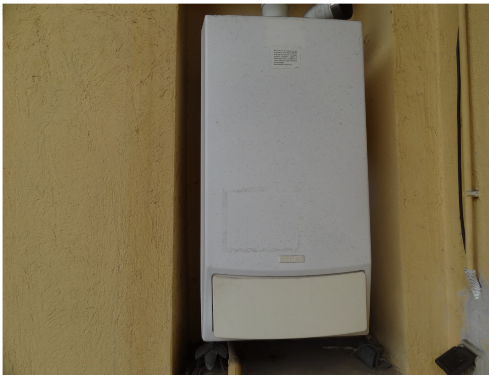
Foto esterna – dettaglio caldaia
