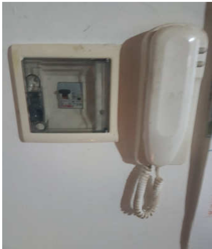
25. particolare del quadretto elettrico del piano e del citofono
