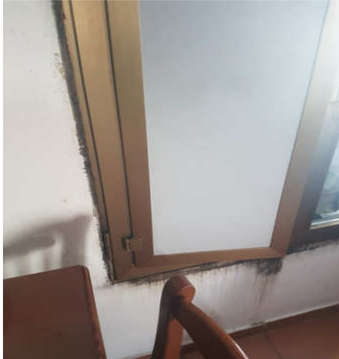
16. particolare del danno da umidità visibile sul muro della finestra del soggiorno per mancanza di riscaldamento dei locali
