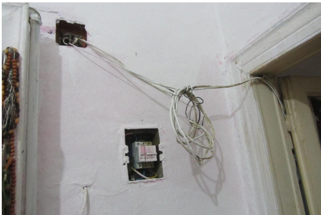
Vista in dettaglio dell'impianto elettrico non a norma.
