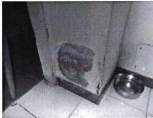
70. Umidità di risalita (corpo scala)
