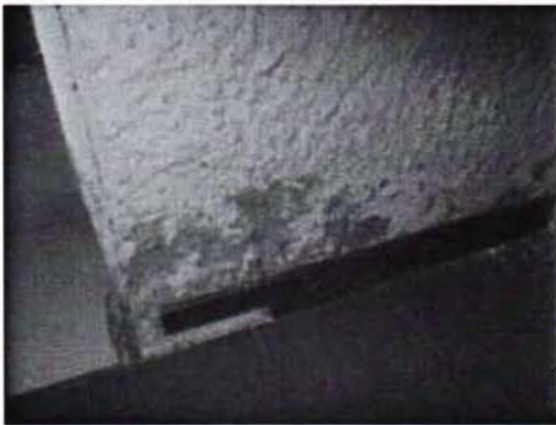
69. Umidità di risalita (taverna)
