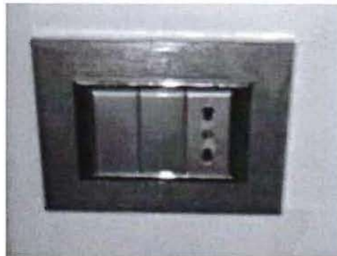
32. Dettaglio corpo elettrico
