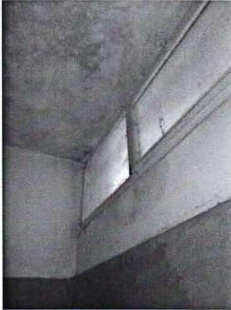
67. Umidità e muffe sul soffitto del bagno
