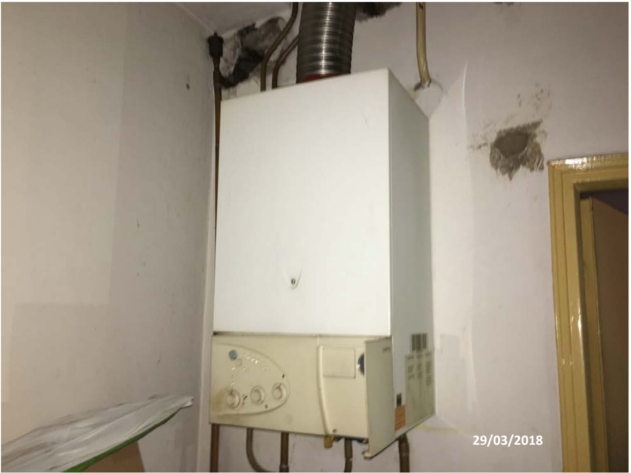
Ingresso-Caldaia a gas
