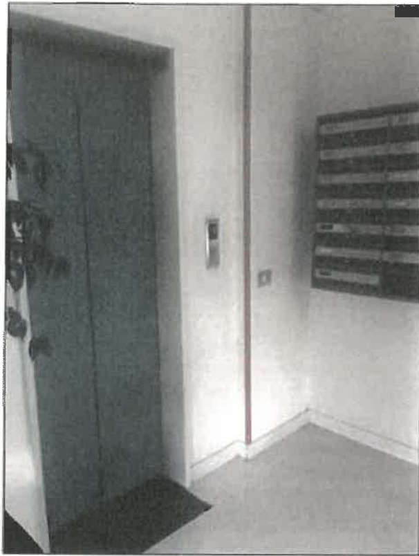
SBARCO ASCENSORE PIANO TERRENO
