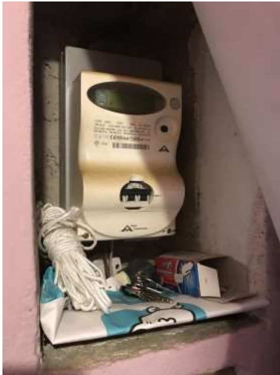
Immagine 13. Il contatore elettrico, collocato all'interno dell'unità immobiliare, nella zona di ingresso.
