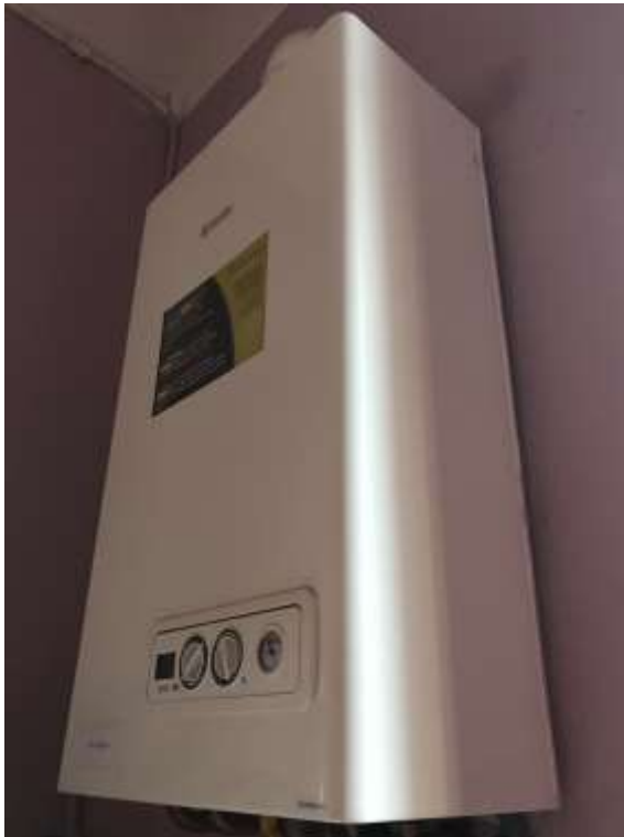
Immagine 20. La caldaia, collocata all'interno della zona giorno.
