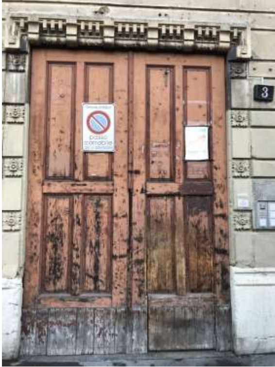
Immagine 1. Il portone in legno di ingresso al fabbricato su via Ottavio Rinuccini.
