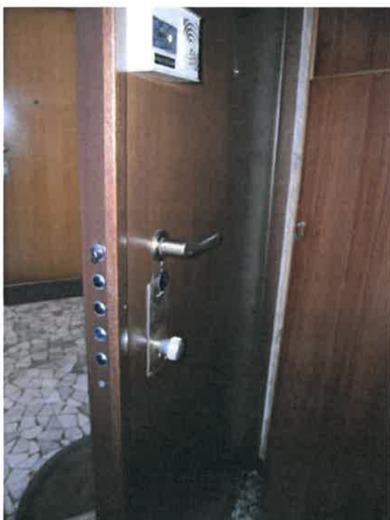
Foto 24 - Dettaglio serramento ingresso
