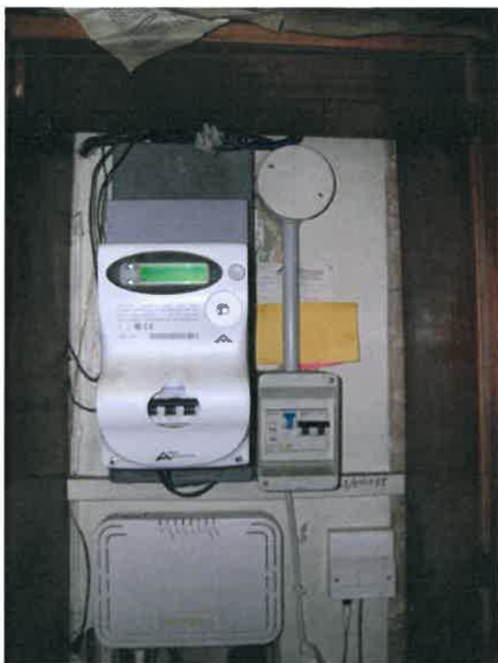
Foto 22 - Cintatore e quadro elettrico
