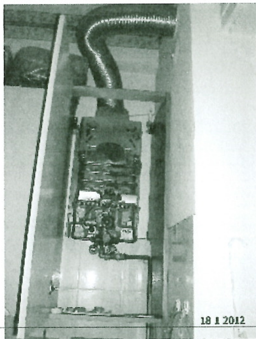
SUB 708 - PIANO 1 - SCALDABAGNO
