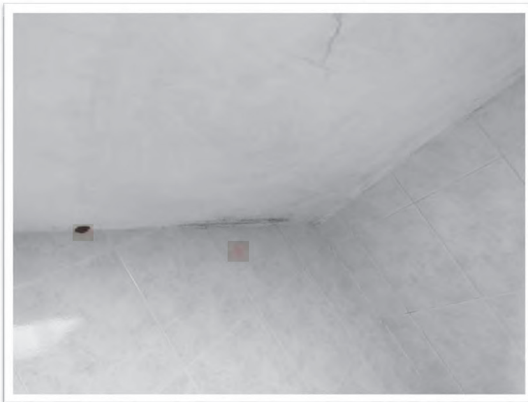
Particolari di degrado/scarsa manutenzione.
