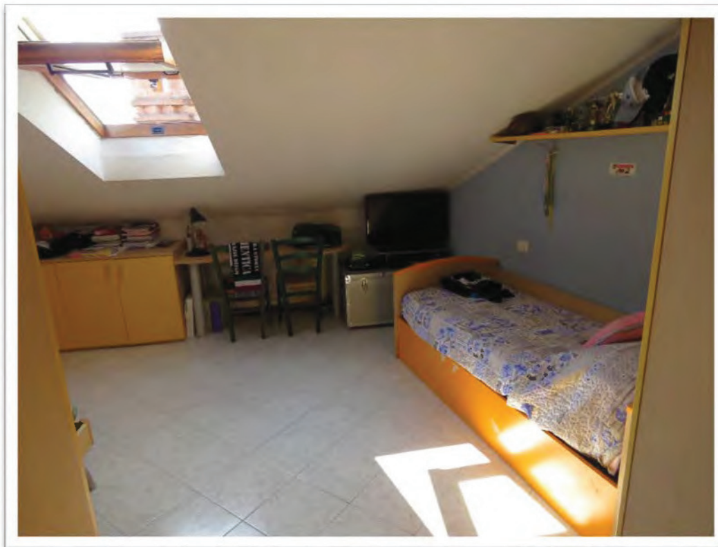
Porzione del solaio/ripostiglio senza permanenza di persone impropriamente utilizzata a cameretta.
