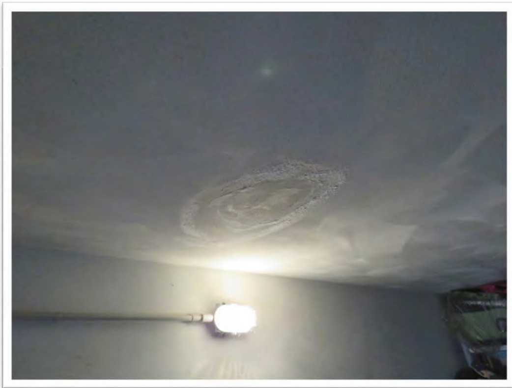
Segni di perdite dal soffitto e rampa carraia.
