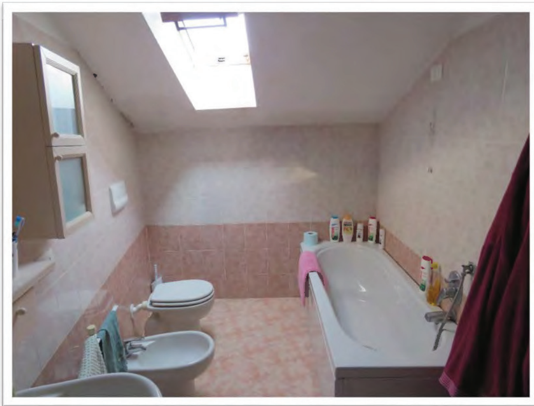
Il bagno – non autorizzato - posto nel solaio/ripostiglio senza permanenza di persone.
