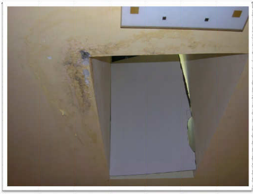
Particolare del degrado del lucemario e vista del disimpegno.
