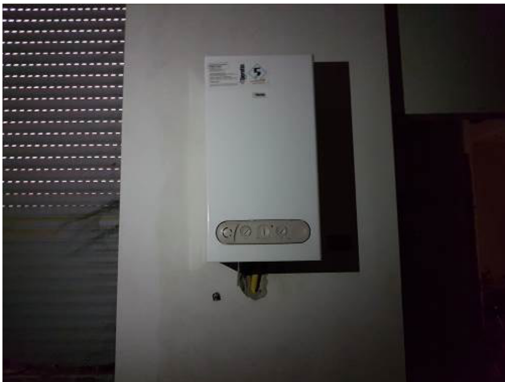
FOTO 13: MILANO, VIALE RAPISARDI 3, caldaia
