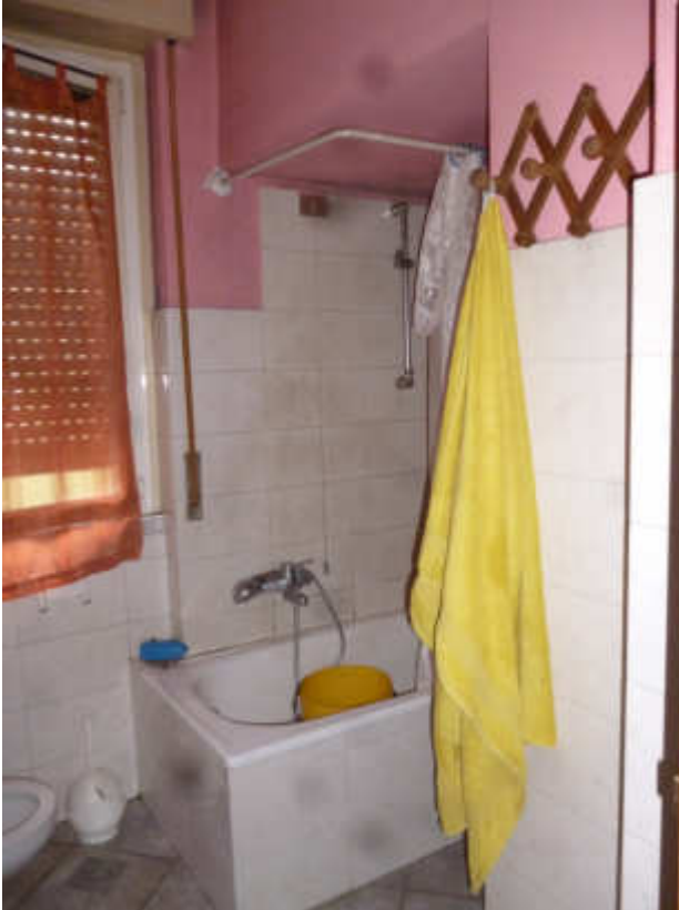
FOTO 13 – Locale bagno e sovrastante controsoffitto
