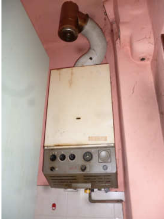
FOTO 7 – Particolare caldaia obsoleta sita nel vano cottura
