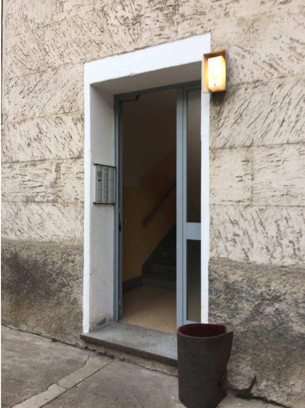
Fotografia n. 11 – Particolare della porta di accesso alla Scala C del Condominio di Via Mac Mahon n. 111, dove si trovano l'appartamento (piano 3), la cantina (piano S1) ed il solaio (piano sottotetto) di proprietà del debitore
