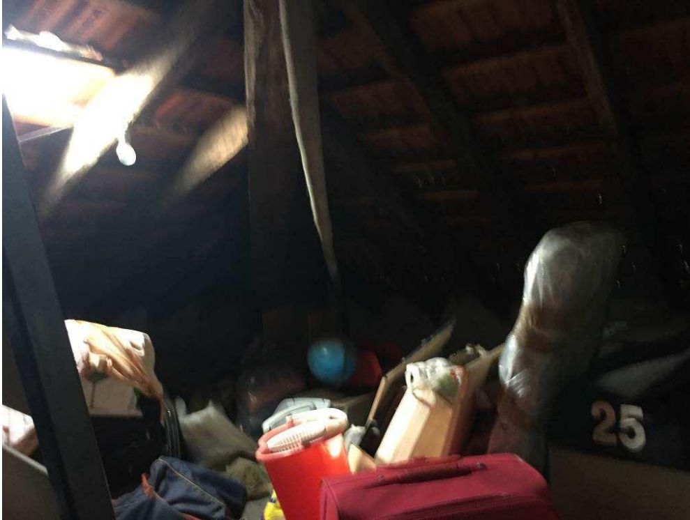
Fotografia n. 35 – Vista dell'interno del locale solaio di proprietà del debitore, al piano sottotetto
