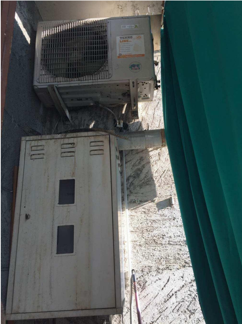
Fotografia n. 21 – Vista del balcone, che affaccia sul cortile interno, a servizio del locale soggiorno/pranzo/angolo cottura, con particolare dello scaldabagno e di uno dei due macchinari esterni dell'impianto di condizionamento
