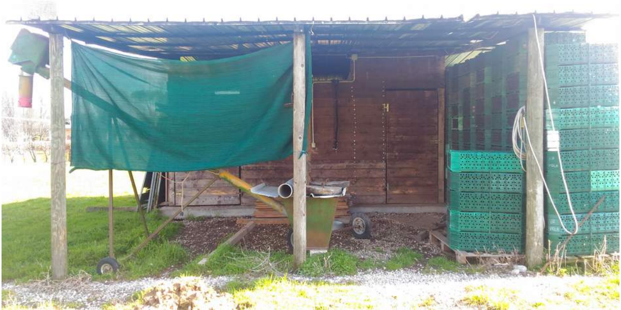
Foto n° 3 - 21/03/2018 - Comune di Pasiano Di Pordenone, foglio 40, part. 29-166-412 sub.1 – Fabbricato con struttura in legno e platea in cemento precedentemente utilizzato come ricovero per equini.
