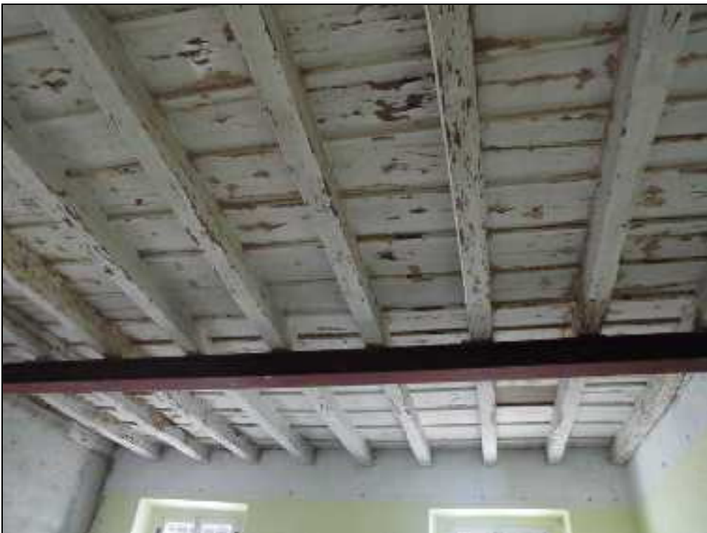
Piano terra – soffitto monolocale
