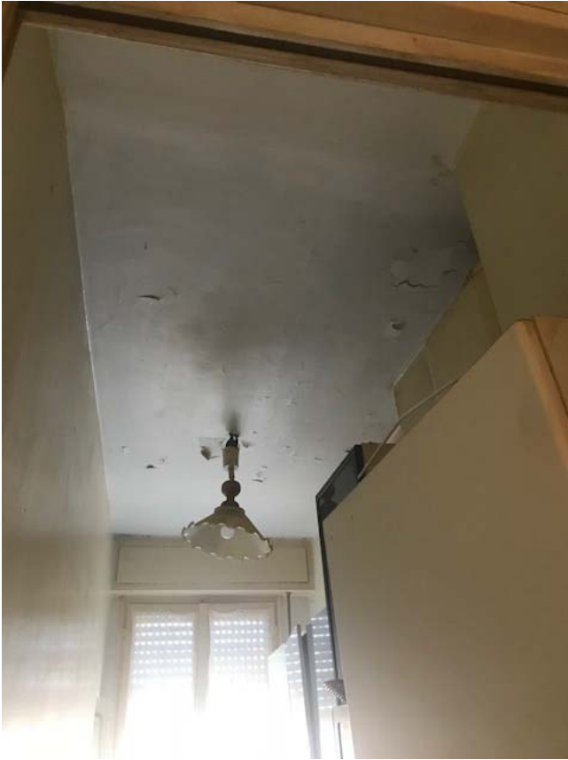
Figura 13 Dettaglio plafone scrostato
