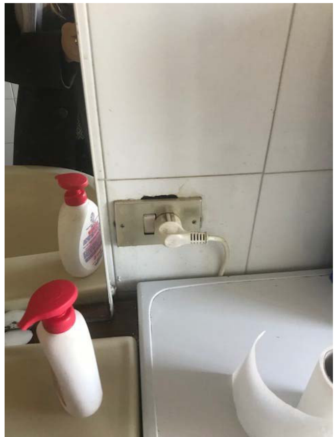
Figura 12 Dettaglio impianto elettrico
