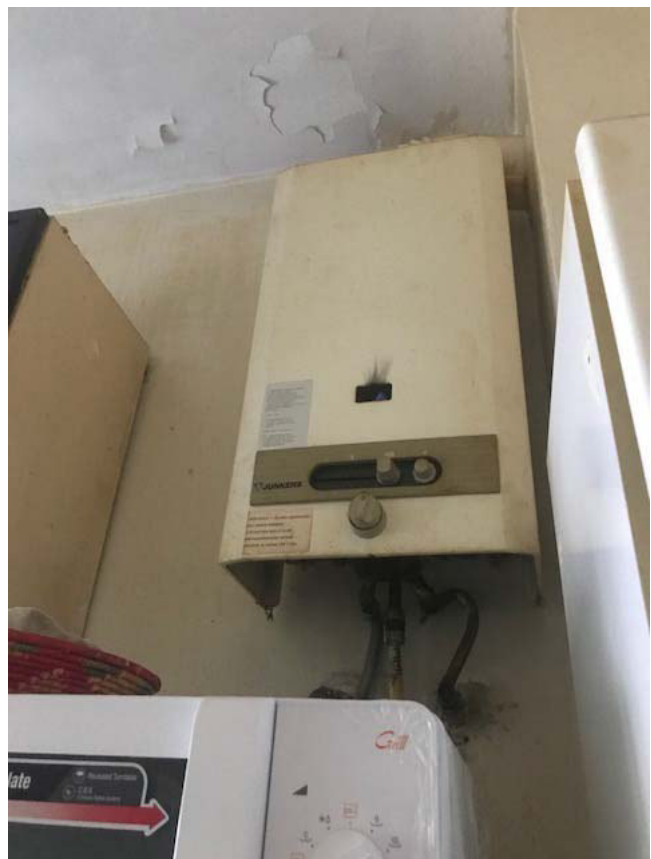
Figura 12 Dettaglio caldaia ACS
