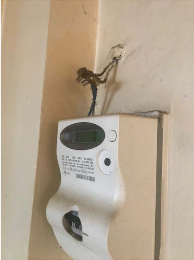
Figura 15 Dettaglio impianto elettrico
