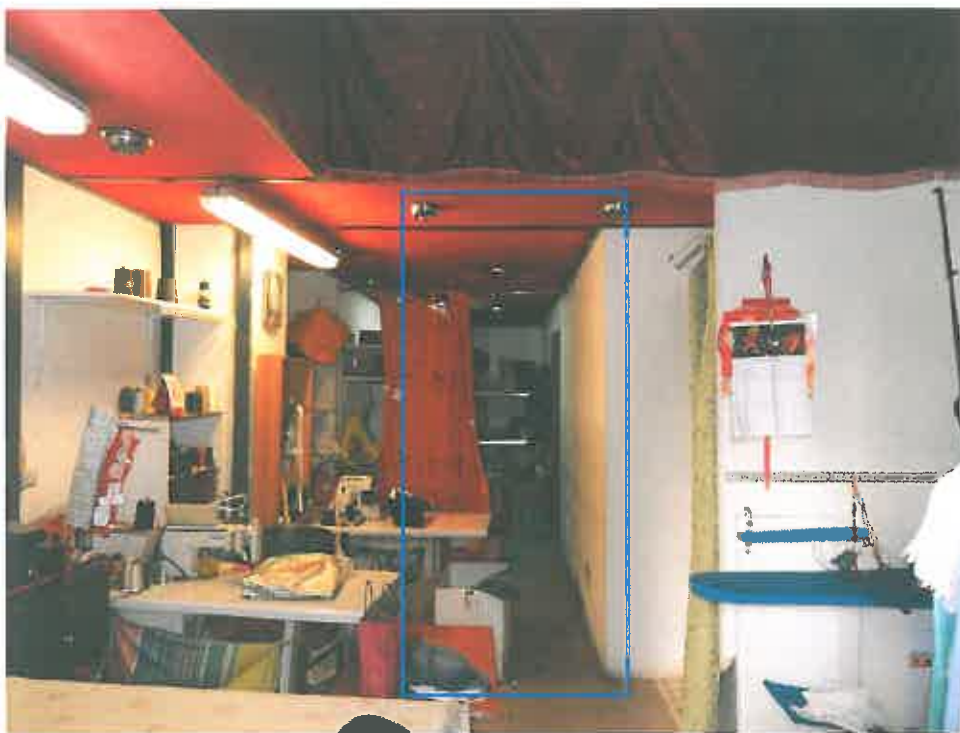
FOTO 5: Interno dell'unità pignorata – Ulteriore vista generale dall'ingresso. Il rettangolo blu indica la porzione di muratura mancante, diversamente da quanto riportato nella planimetria catastale.
