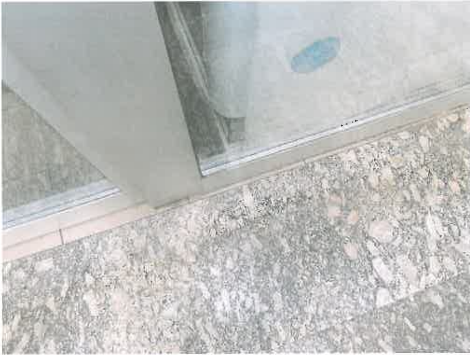
FOTO 12: Dettaglio esterno del serramento della vetrina dell'unità pignorata.
