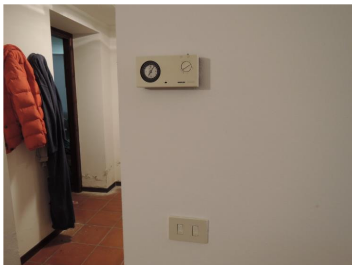
particolare impianto elettrico e di riscaldamento
