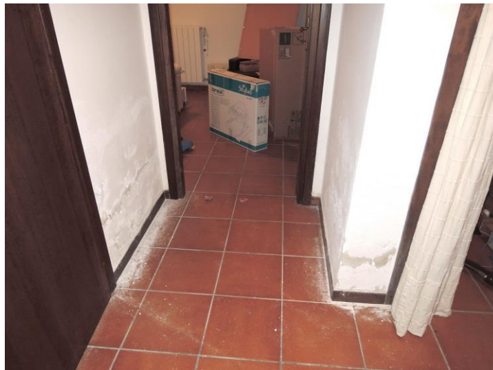
particolare infiltrazioni di umidità sulle pareti del piano seminterrato
