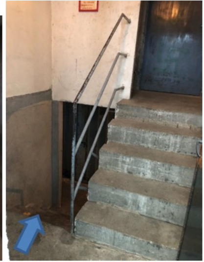
scala d'accesso al piano interrato in cui vi è la cantina (accessorio dell'unità principale)
