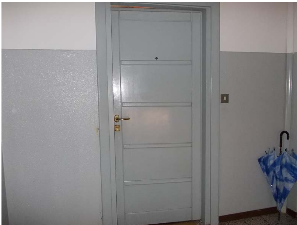
Porta di accesso all' unità
