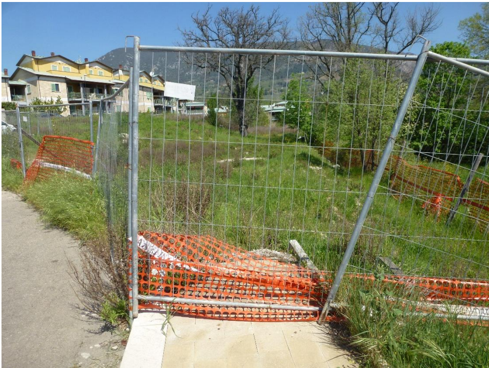
Foto n.08 – Area adibita a strada non realizzata
