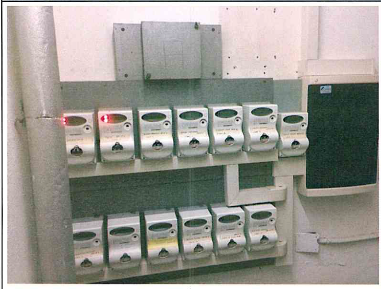
Particolare quadri elettrici unità immobiliari condominio
