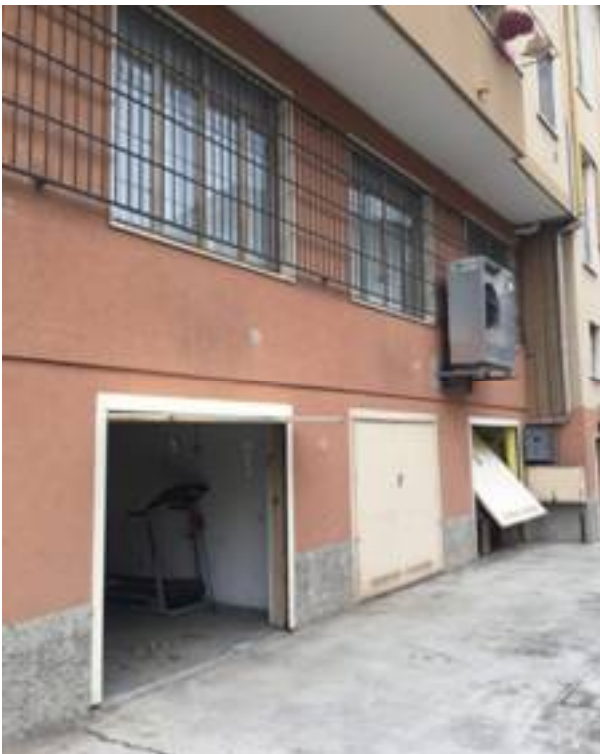
Fig.11: vista del box dal corso di manovra.
