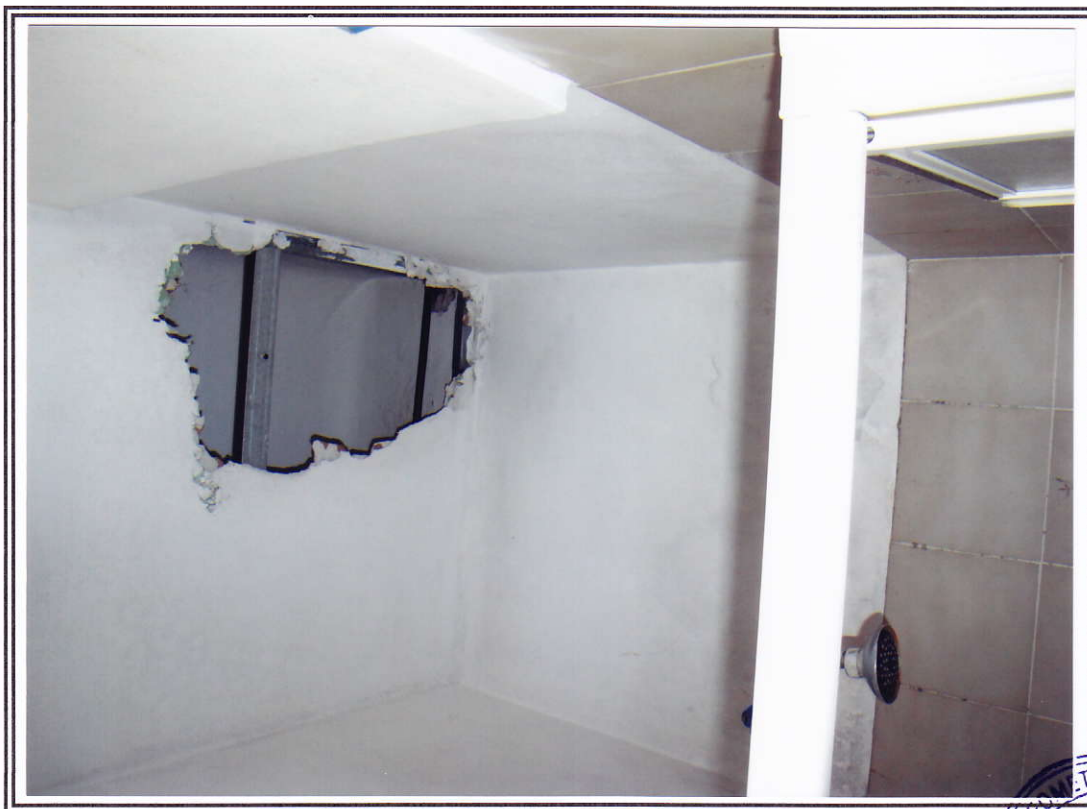
Interno appartamento – bagno controsoffitto danneggiato
