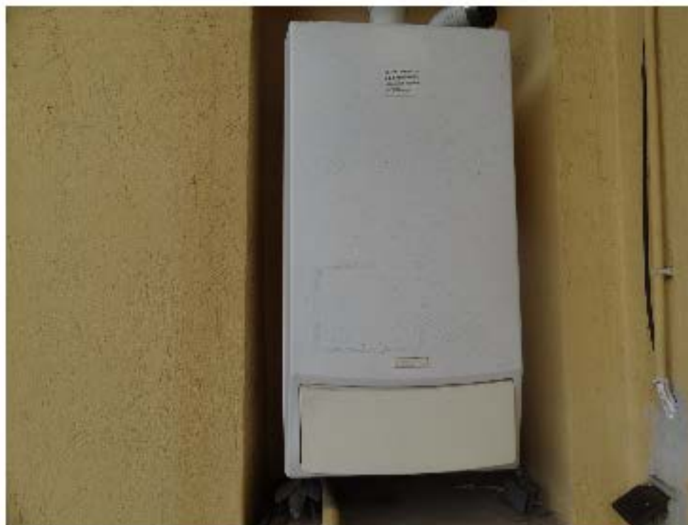
Foto esterna – dettaglio caldaia
