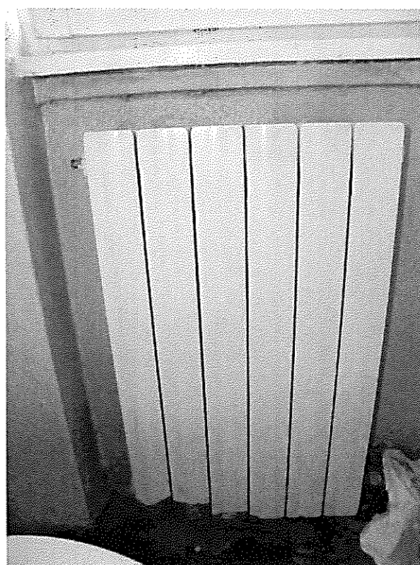
Bagno – Particolare termosifoni
