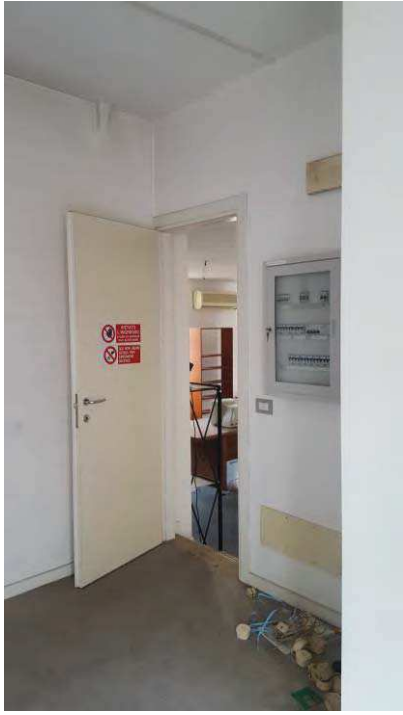
LOCALE TECNICO P1
