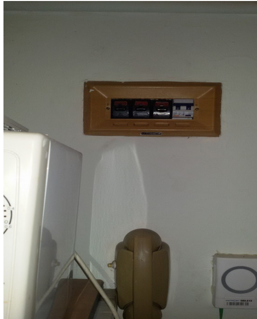
quadro elettrico ingresso
