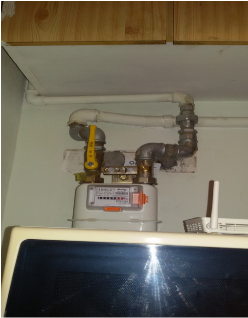
Contatore gas ingresso
