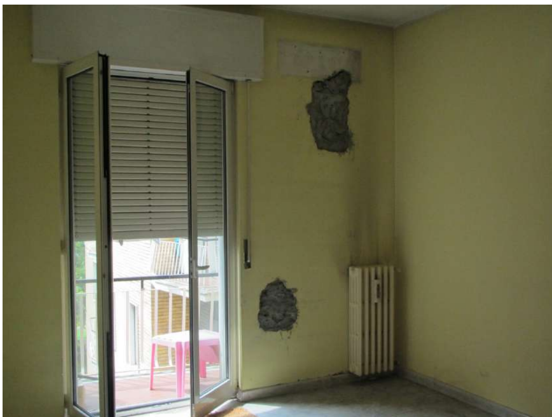
Zona del soggiorno ove era ubicato uno dei condizionatori tipo "split"
