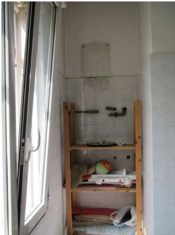
Zona della cucina ove era ubicata la caldaia a gas metano per la produzione dell'acqua calda sanitaria
