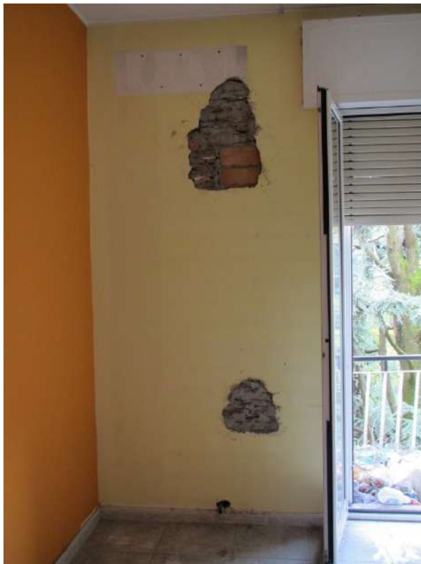
Zona della camera da letto ove era ubicato uno dei condizionatori tipo "split"
