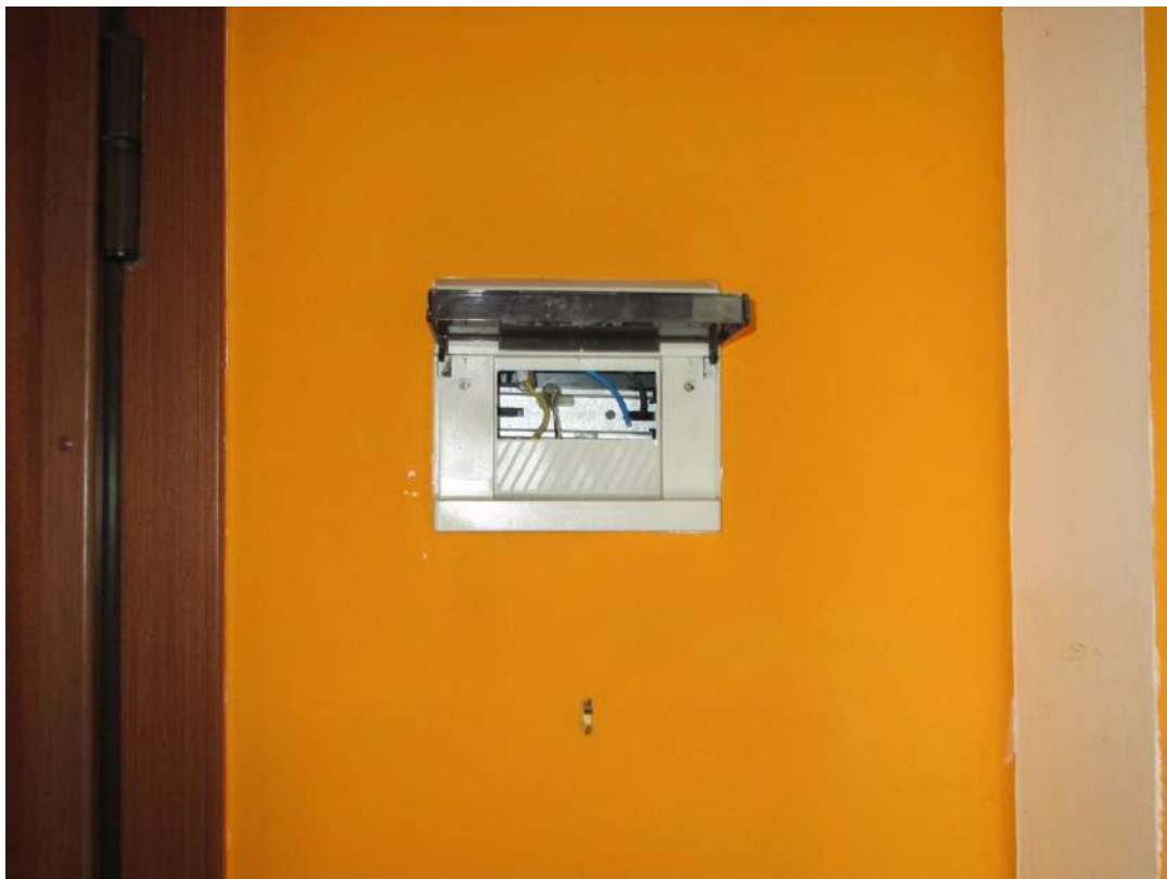
Dettagli – Quadro elettrico
