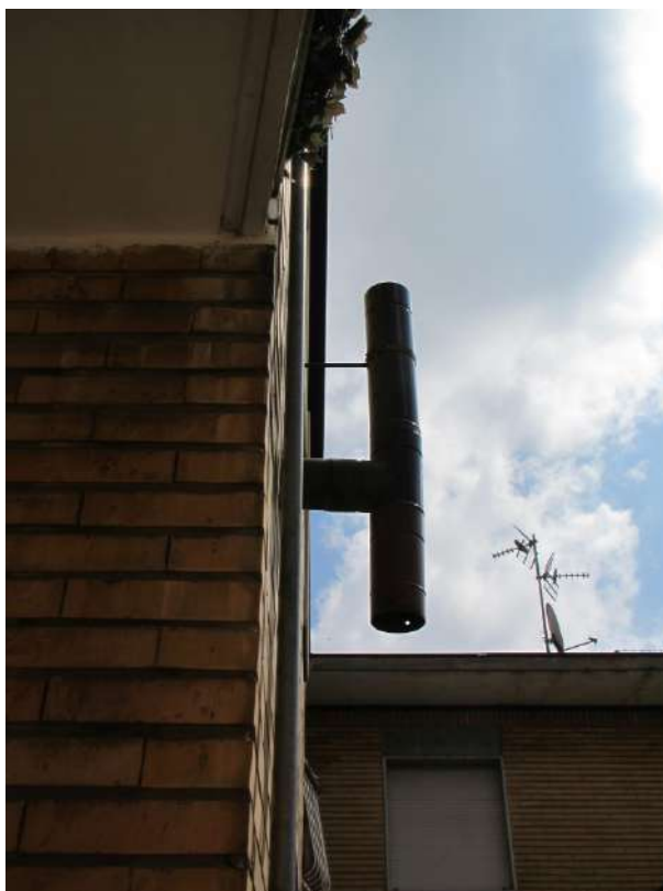
Dettagli – Canna fumaria della caldaia a gas metano per la produzione dell'acqua calda sanitaria
