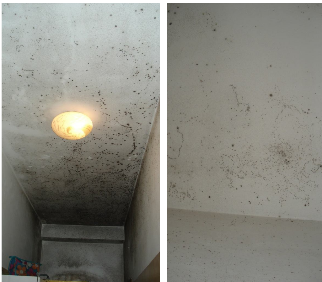
Foto 9: vista generale delle macchie e dettaglio
