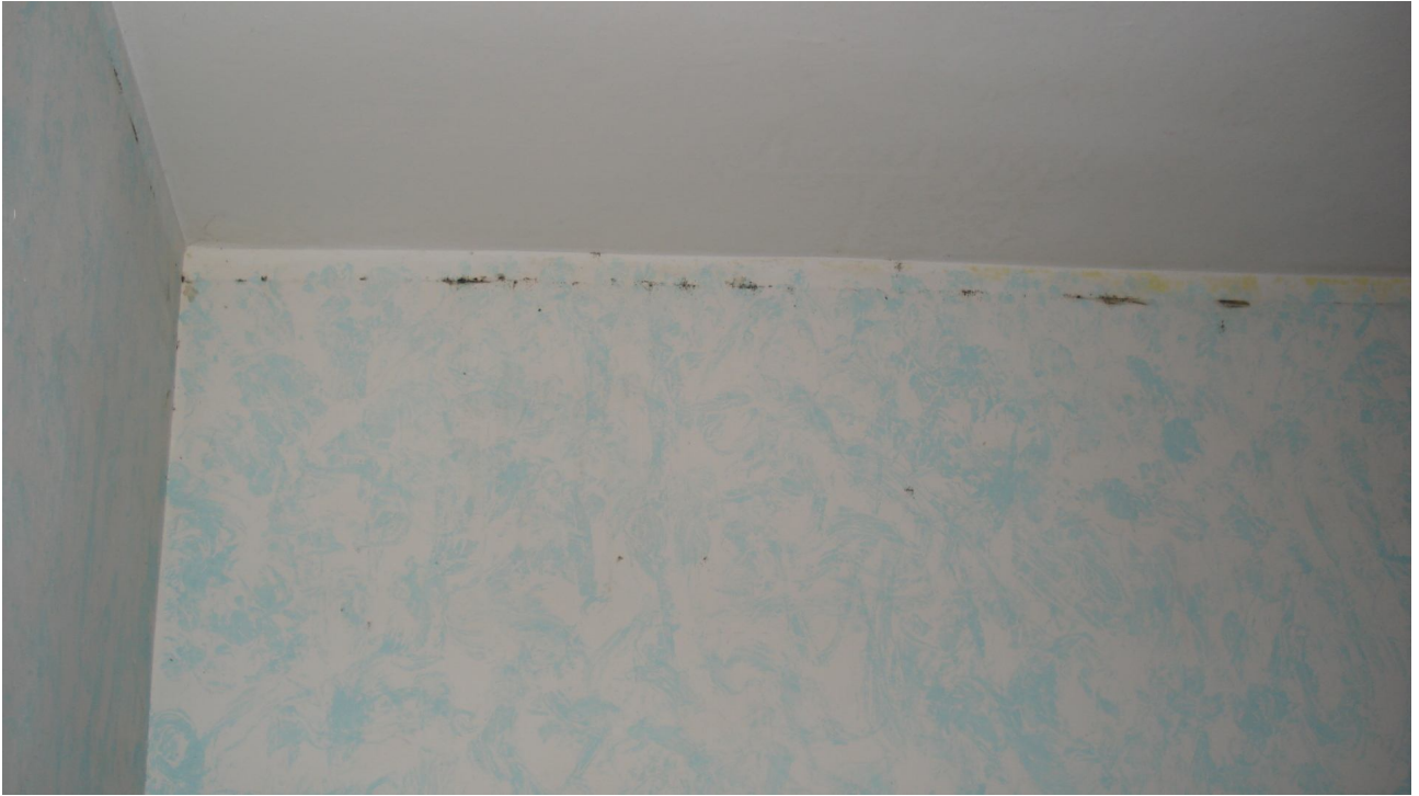
Foto 15: vista macchie in camera
