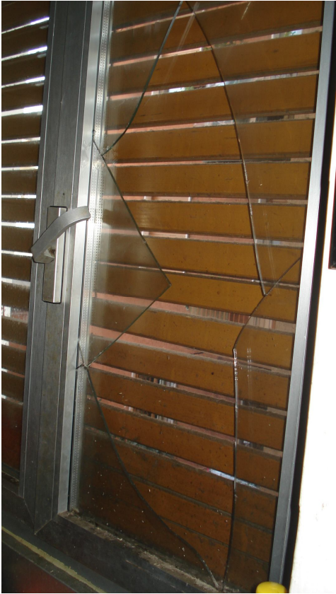
Foto 13: vista serramento e tapparella rotta dell'angolo cucina
