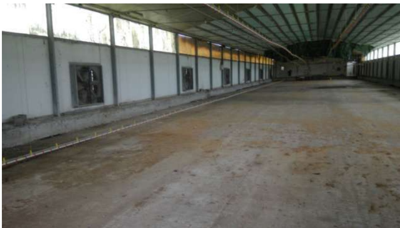
Foto n. 6 – Comune di San Martino al Tagliamento (PN), Lotto 4 - Foglio 11, particella 375 – Zona di allevamento e particolare del sistema di ventilazione all'interno del capannone pignorato.
