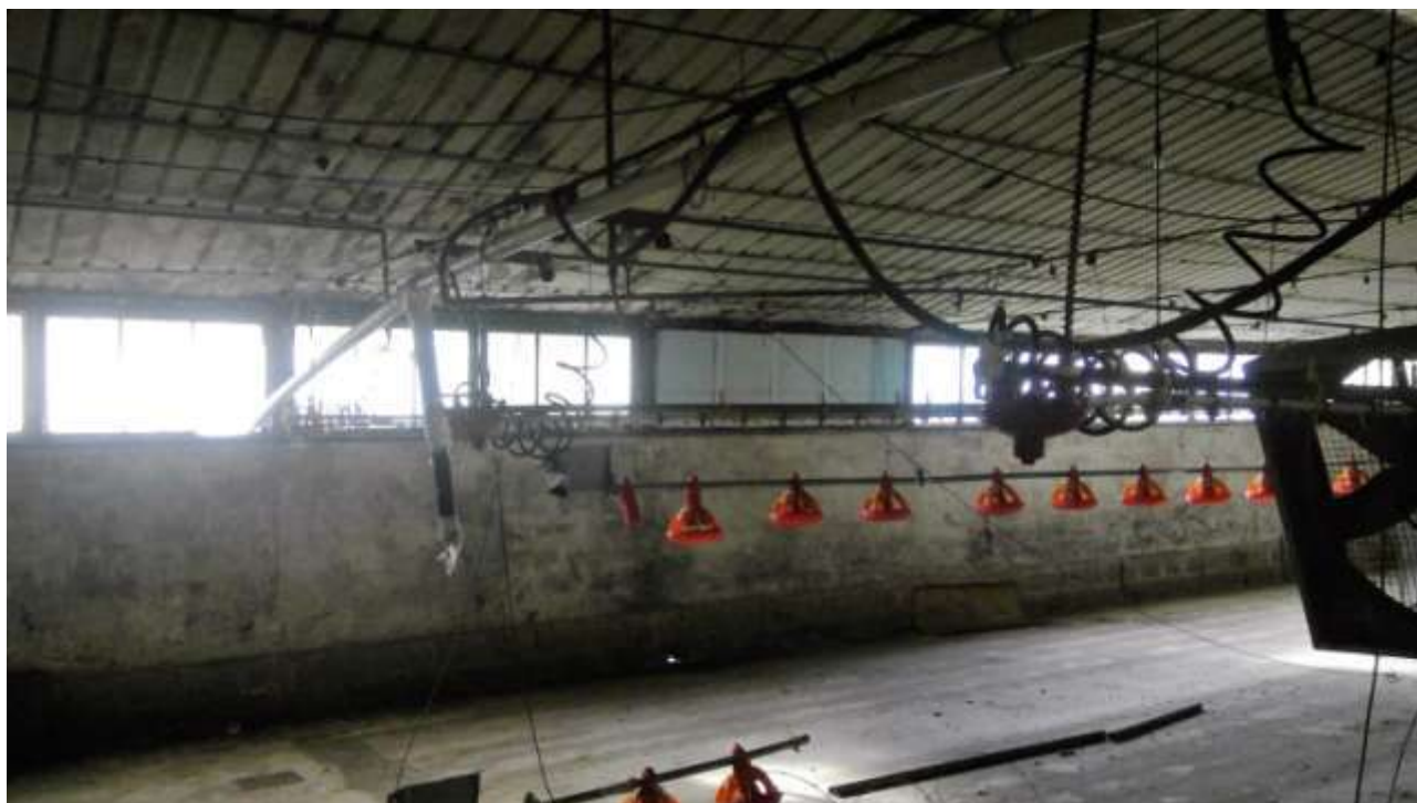
Foto n. 11 – Comune di San Martino al Tagliamento (PN), Lotto 3 - Foglio 11, particella 86 – Particolare degli impianti uso allevamento ovaiole all'interno del capannone principale.
