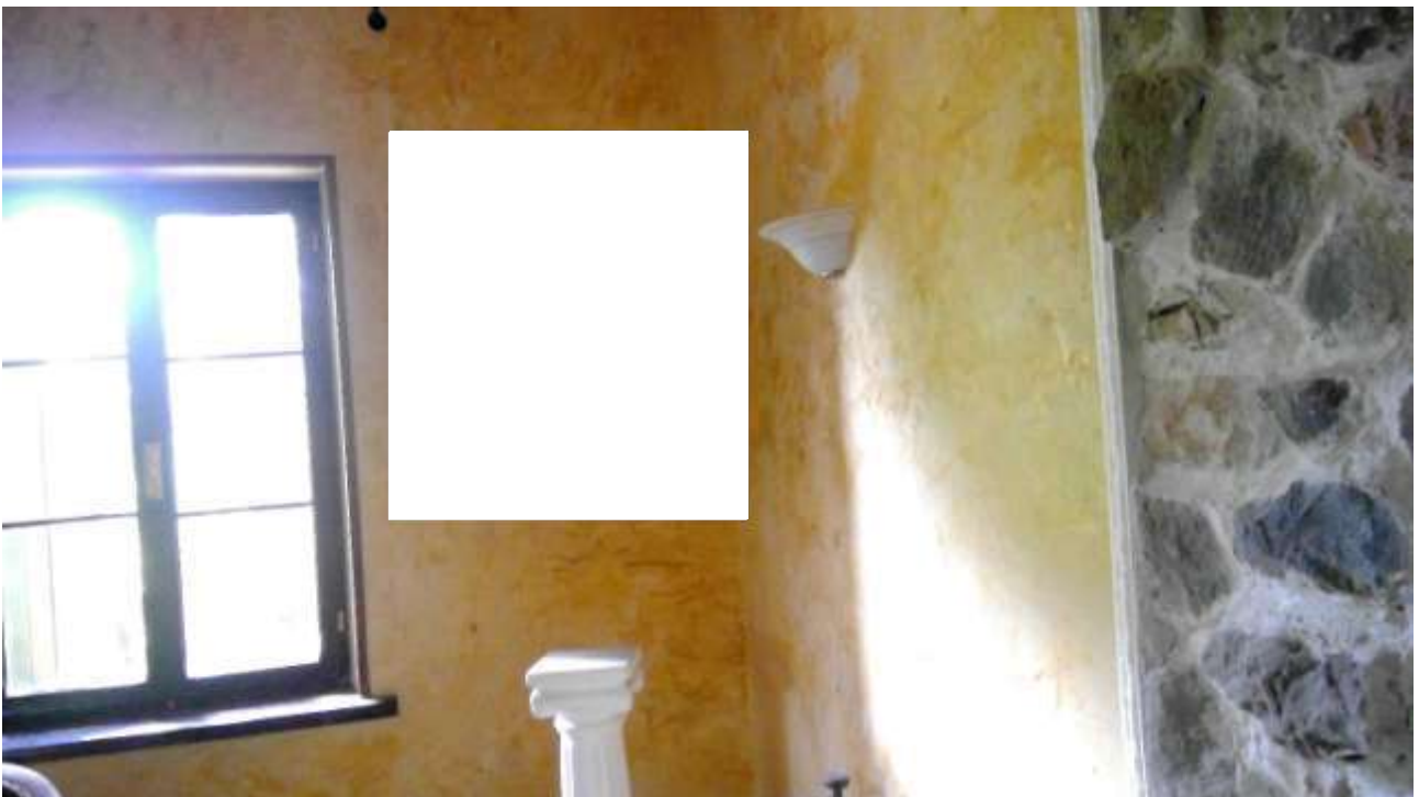
Foto n. 12 – Comune di San Martino al Tagliamento (PN), Lotto 2 – Foglio 10, particella 5 – Piano terra – vista interna di parte del secondo vano a destra rispetto all’ingresso, indicato con il n. 2 nella planimetria.
