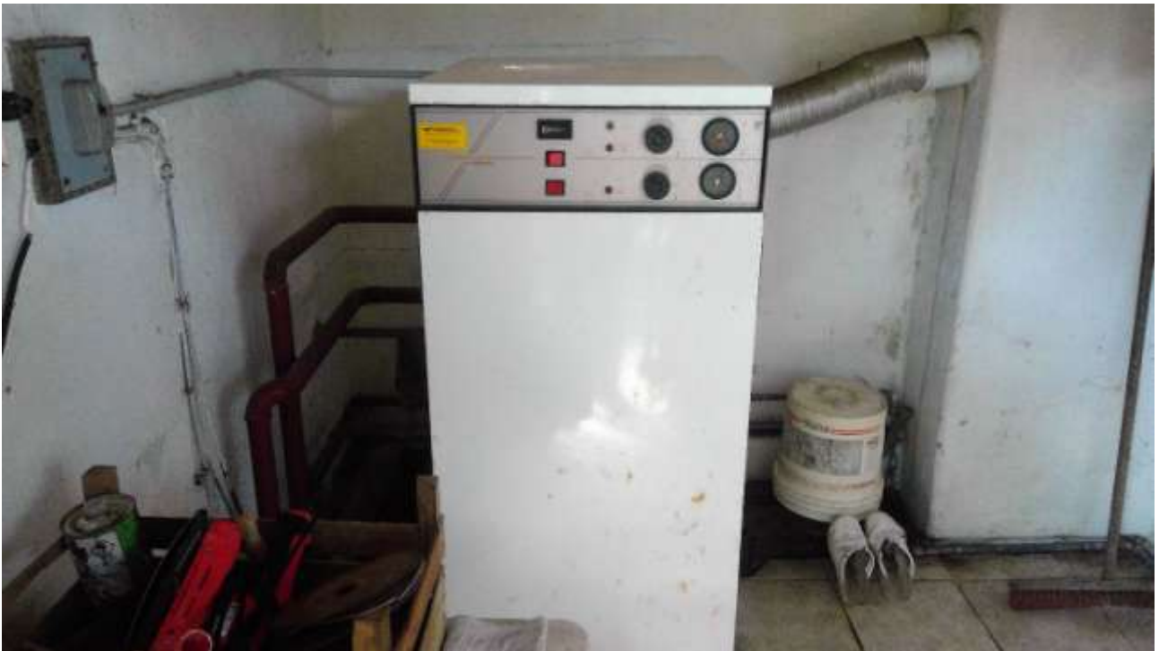
Foto n. 30 – Comune di San Martino al Tagliamento (PN), Lotto 1 – Foglio 5, particella 500 – particolare del vano caldaia all'interno dello stesso fabbricato.
