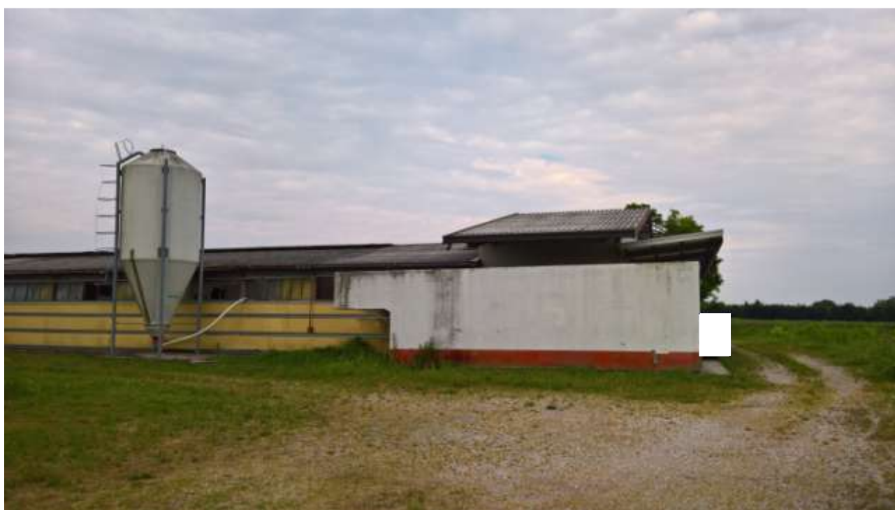
Foto n. 2 – Comune di San Martino al Tagliamento (PN), Lotto 3 - Foglio 11, particella 86 - Veduta parziale, da posizione ovest, del terzo capannone pignorato.
