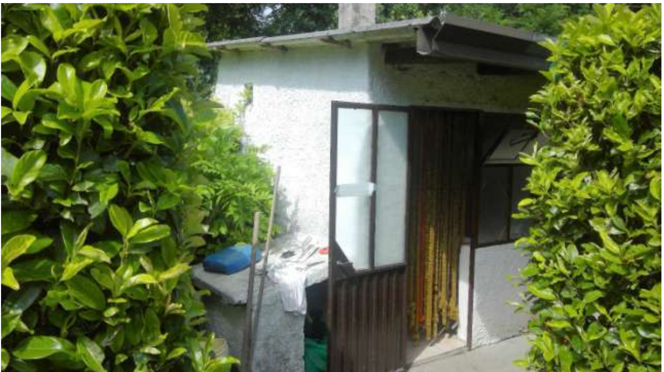
Foto n. 28 – Comune di San Martino al Tagliamento (PN), Lotto 1 – Foglio 5, particella 500 – veduta esterna del fabbricato uso vano caldaia-legnami e annessi rustici che non risulta autorizzato.
