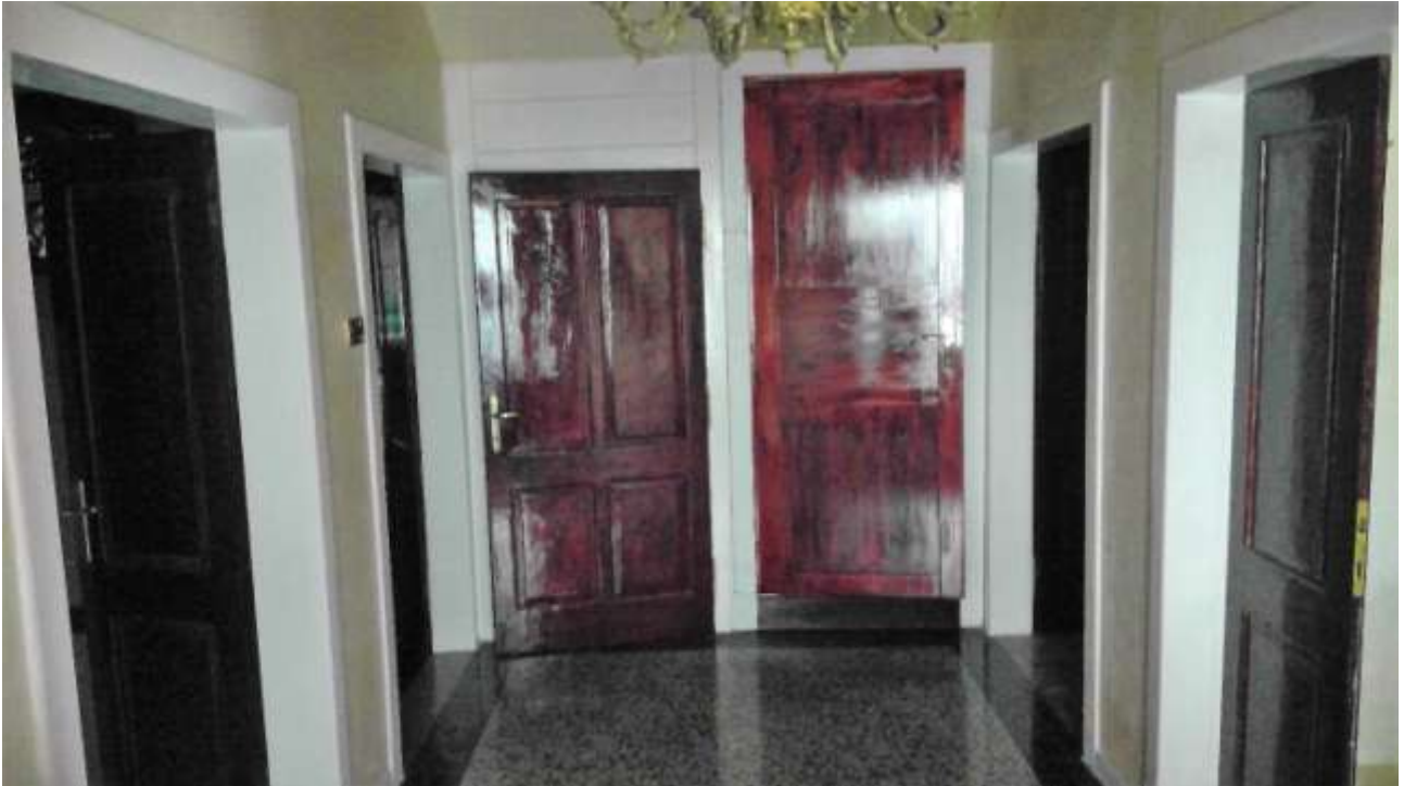
Foto n. 3 – Comune di San Martino al Tagliamento (PN), Lotto 2 – Foglio 10, particella 5 – vista del corridoio di accesso ai diversi vani del piano terra.
