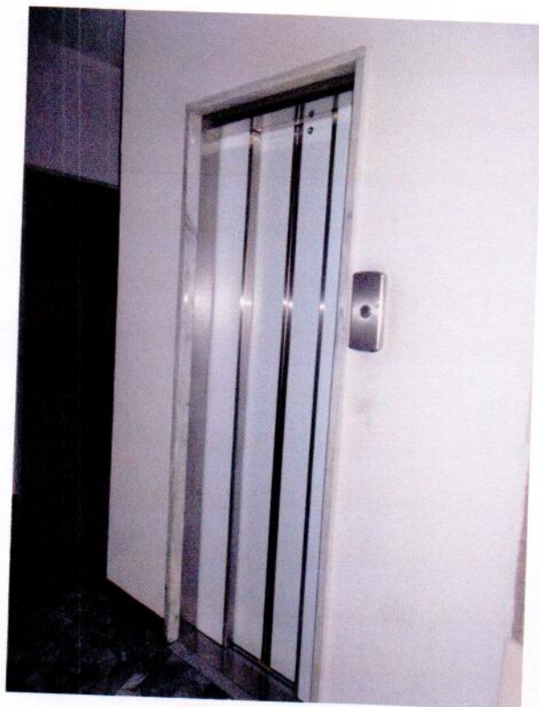
7. Ascensore al piano
