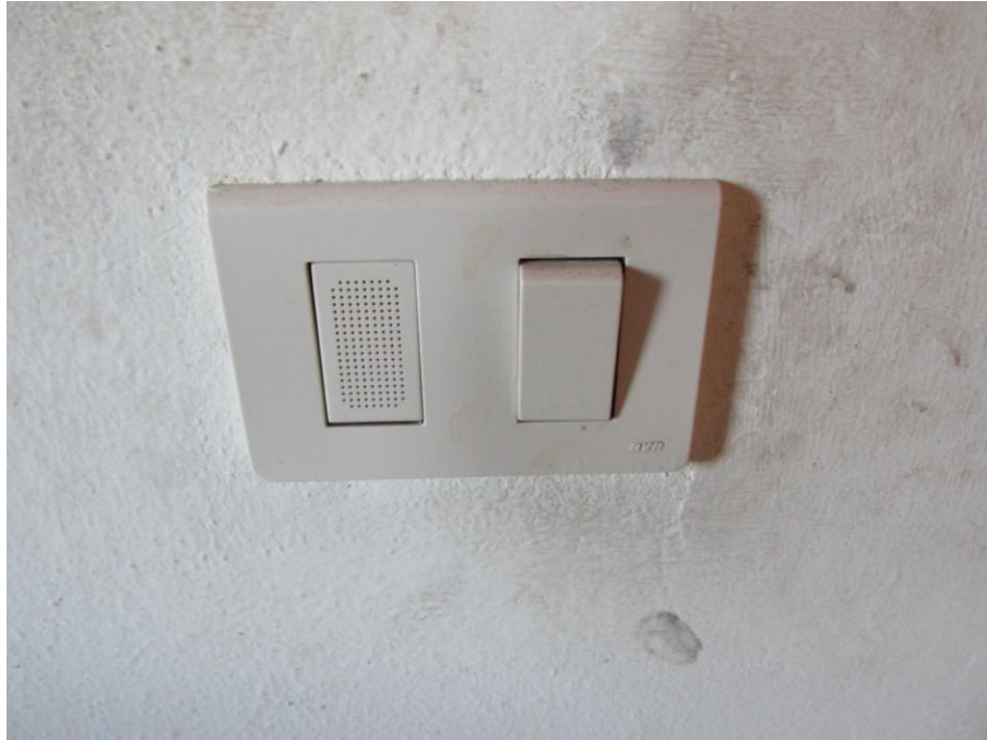
Fig.17: tipologia frutti impianto elettrico
