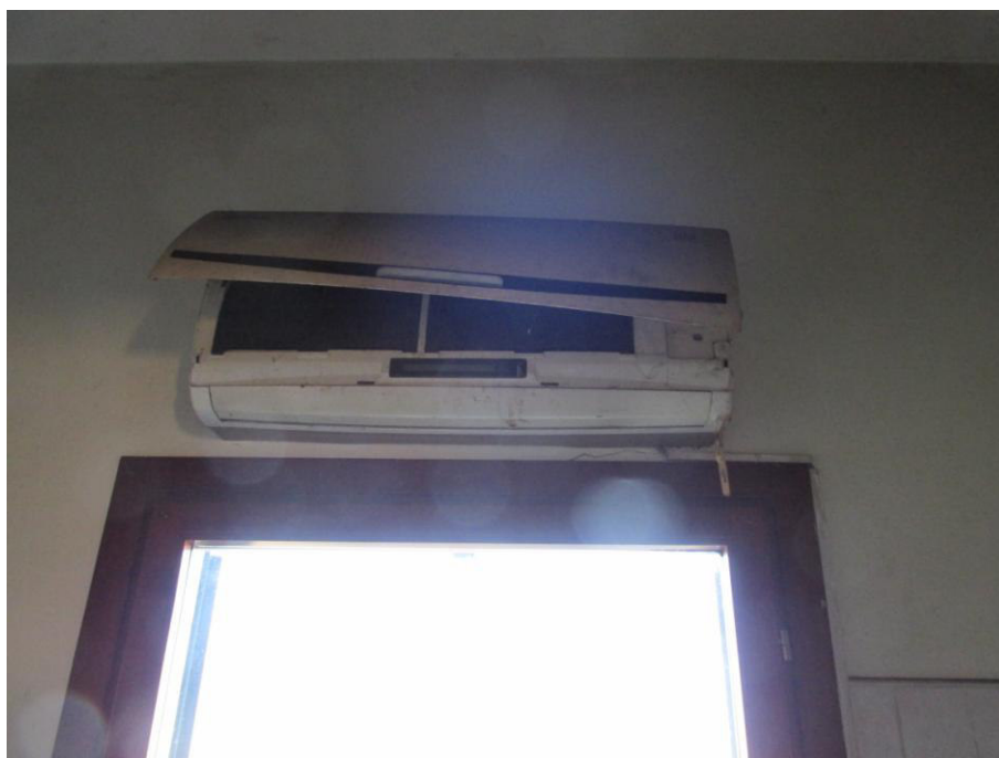
Fig.18: unità di climatizzazione non funzionante
