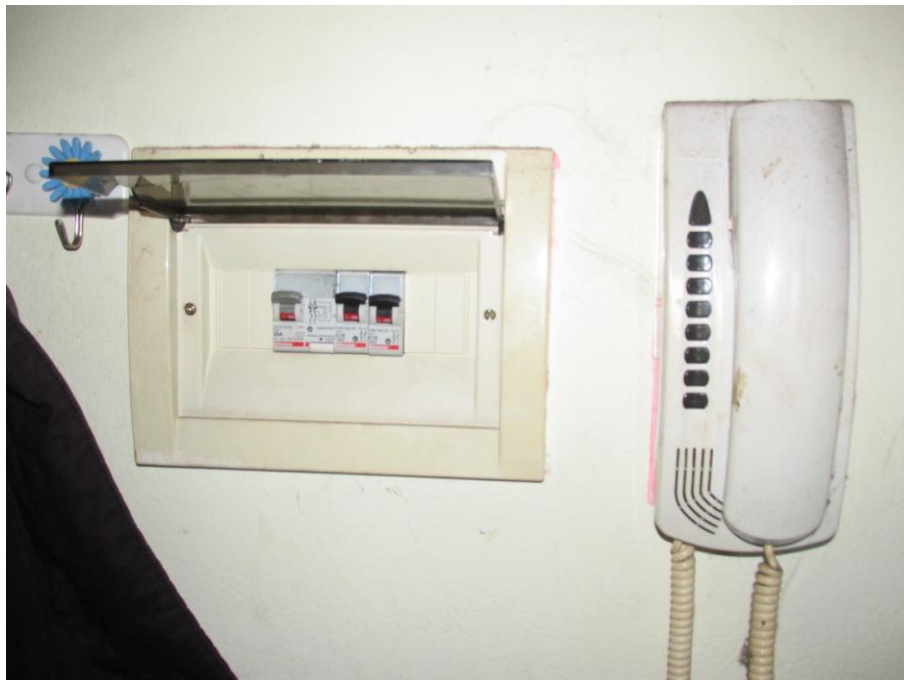
Fig.16: particolare quadro elettrico e citofono
