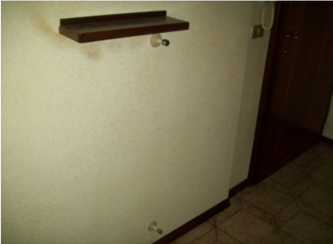
Foto 3: Particolare radiatori staccati
