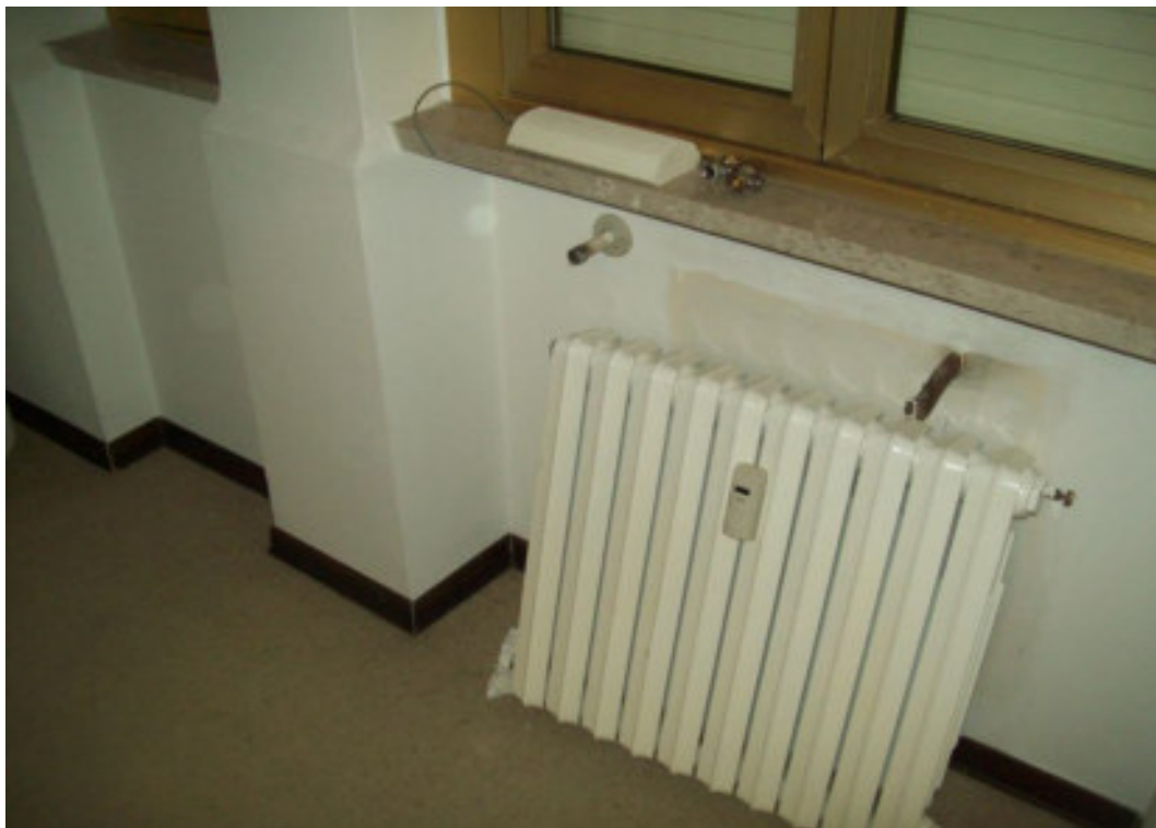
Foto 11: Particolare radiatore camera
