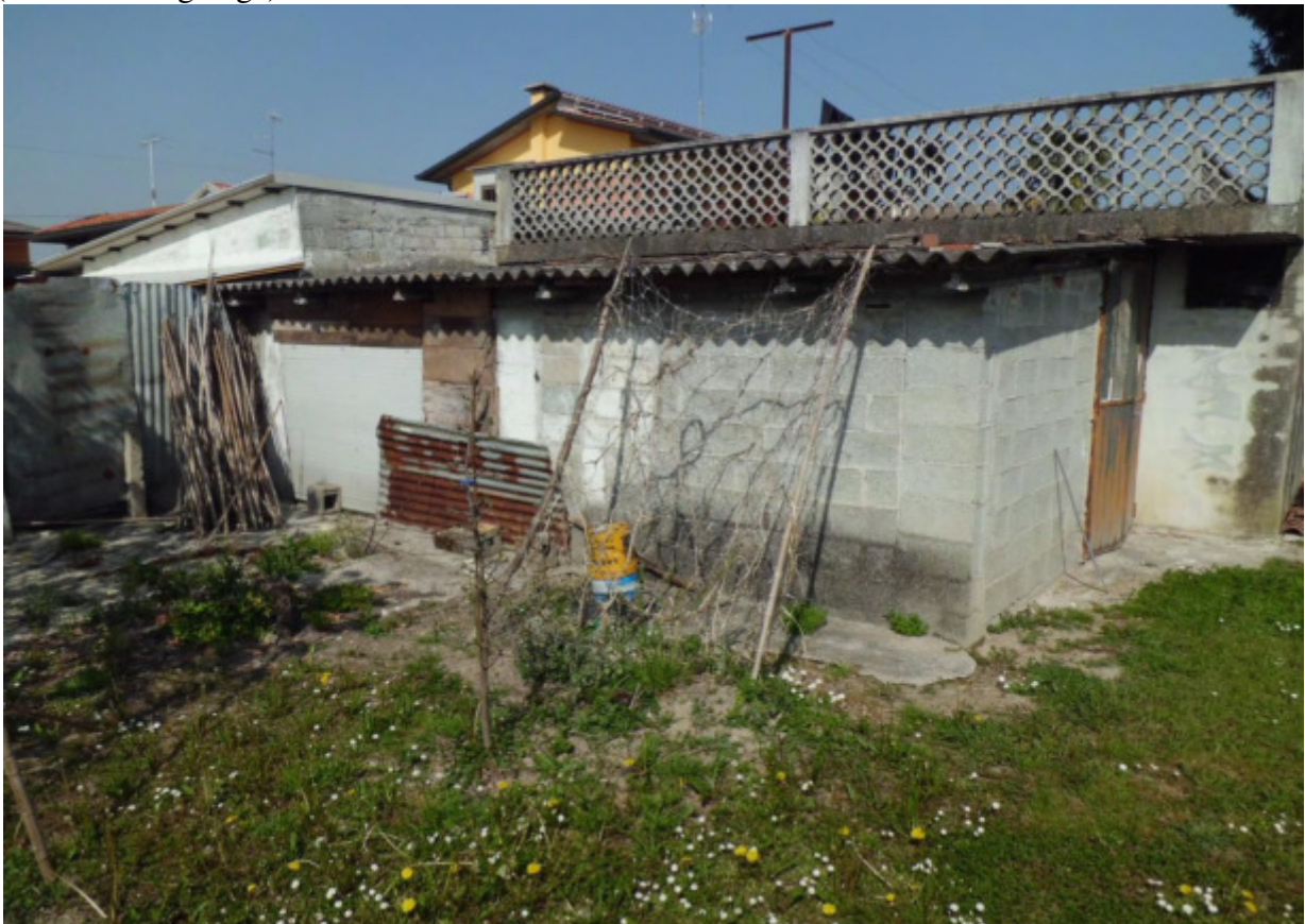
Foto n. 15 – 21.04.2015 – Lotto n. 1 - Comune di San Michele al Tagliamento, fg.24 - Vista esterna della particella 891, struttura adibita a deposito. La copertura presente è in eternit.
