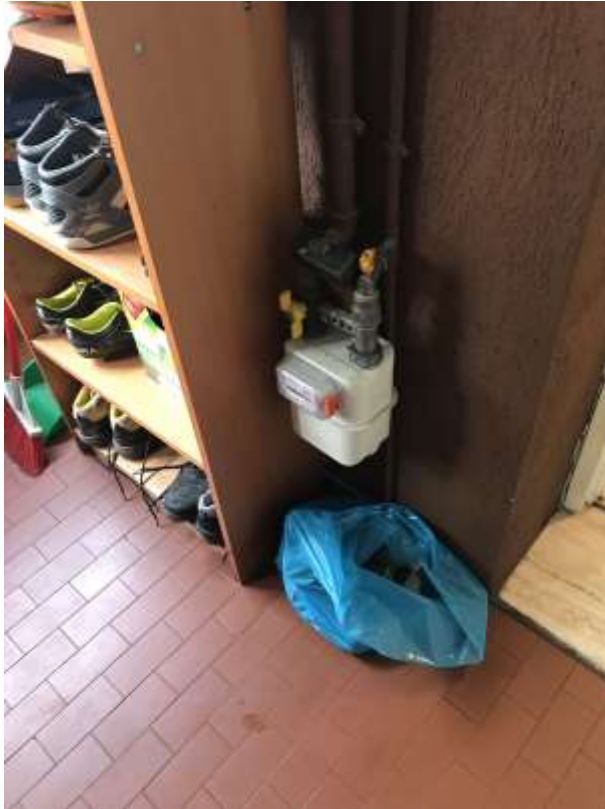
Foto 21. Vista del contatore del gas, collocato sul balcone.
