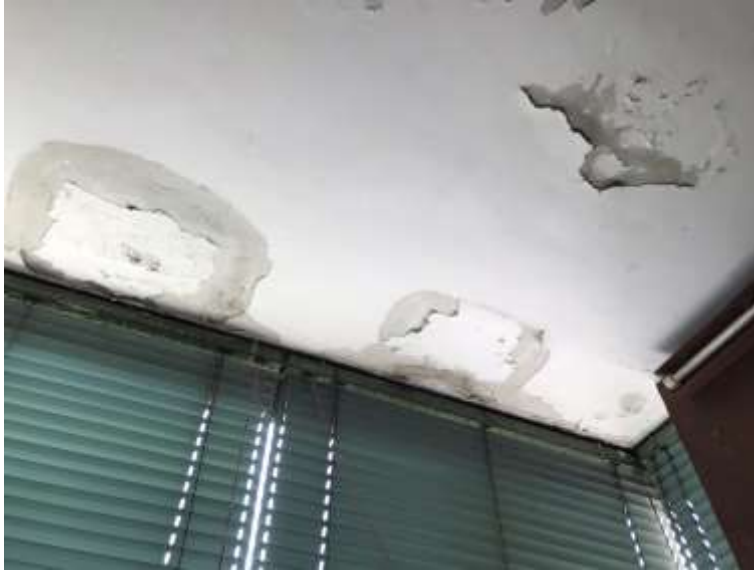
Foto 19. Vista del soffitto del balcone, dettaglio dei segni di degrado dovuti a infiltrazioni dalla copertura o dalla gronda.
