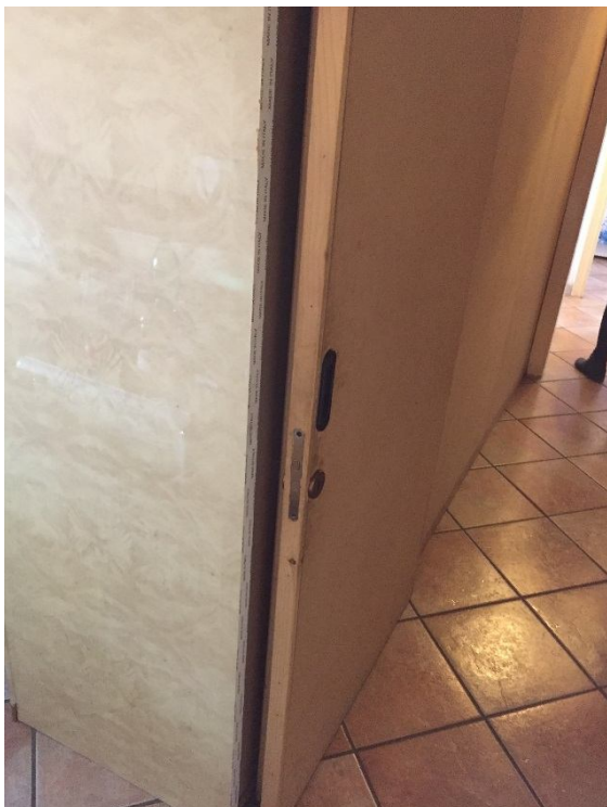
Foto 11: vista parete abusiva in legno
