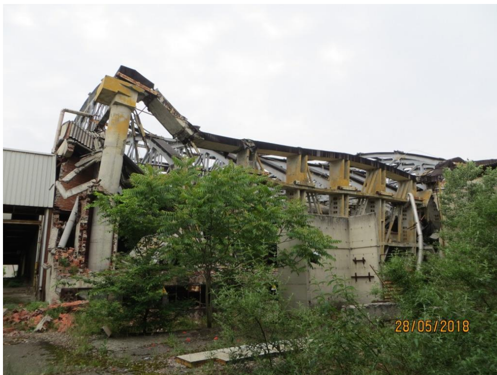
Foto 23 – Area "ex Compressori" particolare dello stato di conservazione e dei crolli
