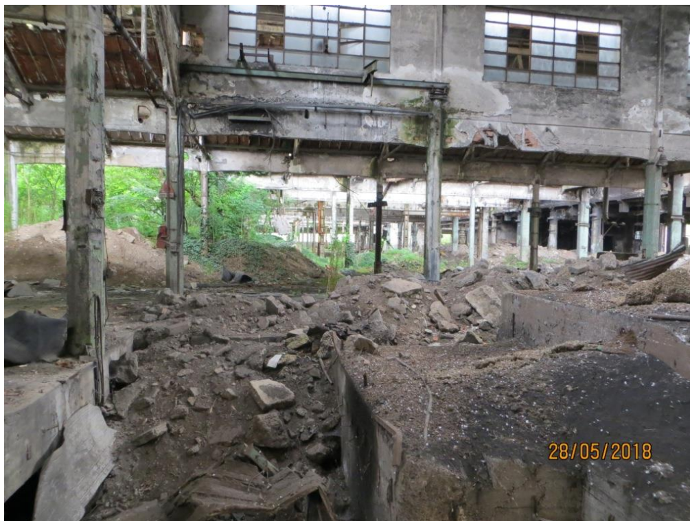
Foto 26 – Area "ex Fonderia" particolare depositi di materiali inquinanti derivanti da attività di fonderia
