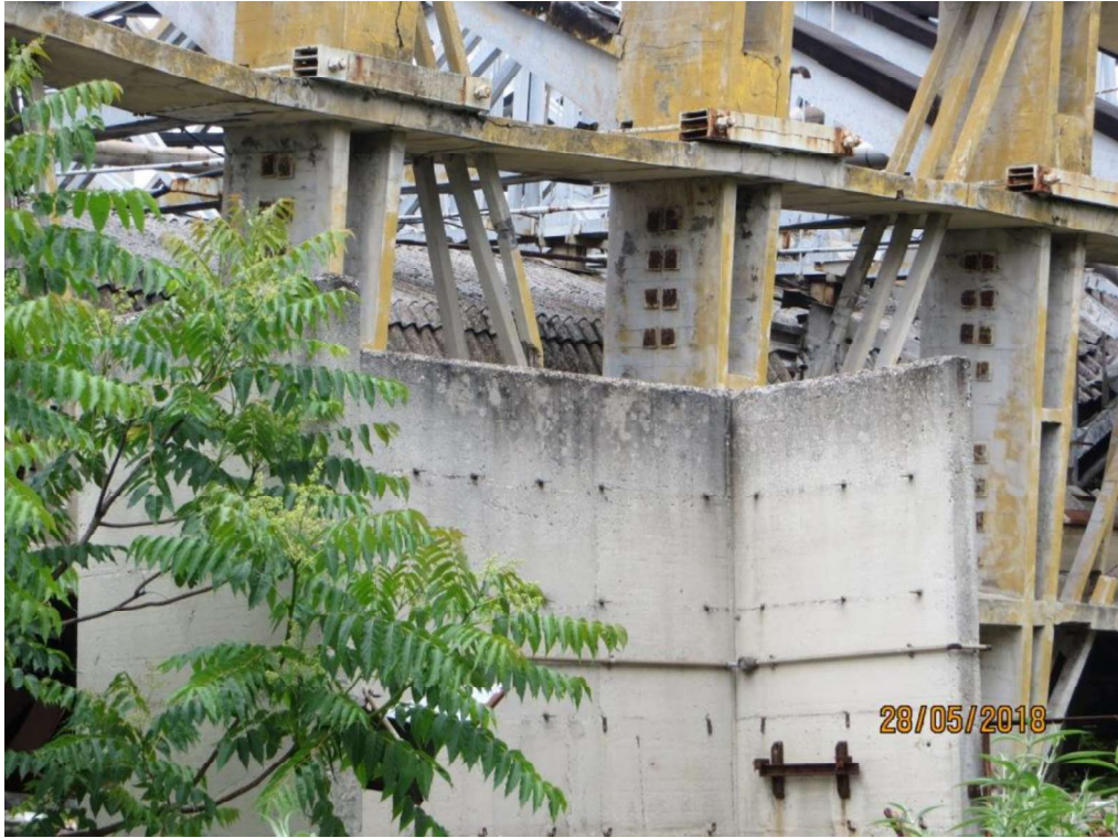
Foto 24 – Area "ex Compressori" particolare dello stato di conservazione e dei crolli
