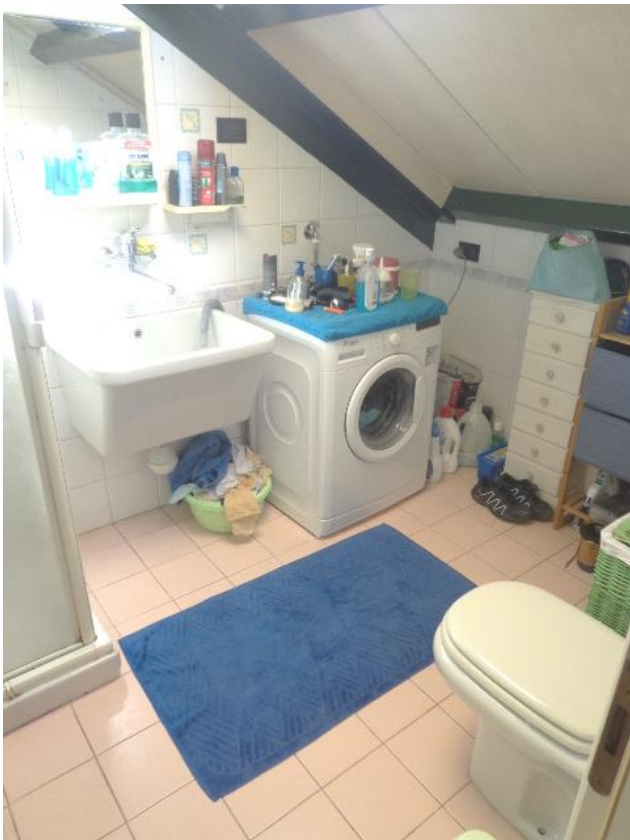
Particolari del locale lavanderia e della caldaia turbo atta alla produzione di acqua calda sanitaria e riscaldamento; locale sottotetto completamente arredato.
