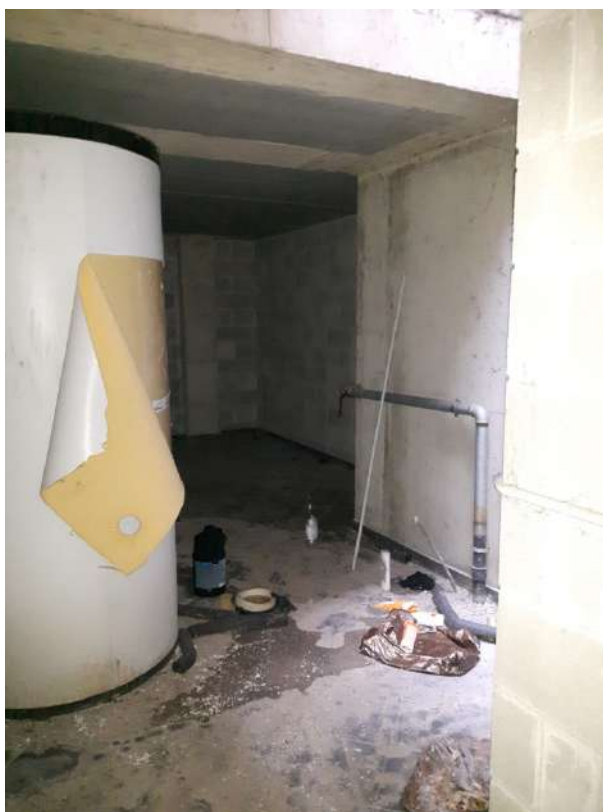
PIANO INTERRATO – Locali Tecnici
