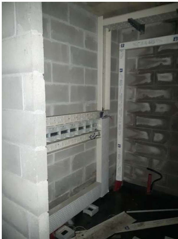
PIANO INTERRATO – Locali Tecnici
