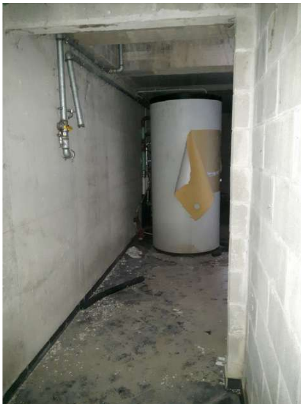
PIANO INTERRATO – Locali Tecnici
