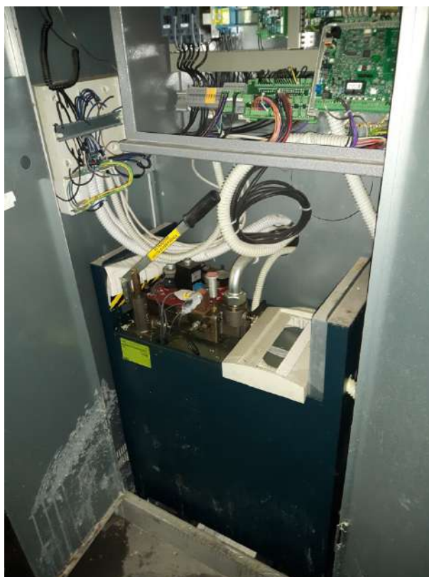
PIANO INTERRATO – Locali Tecnici
