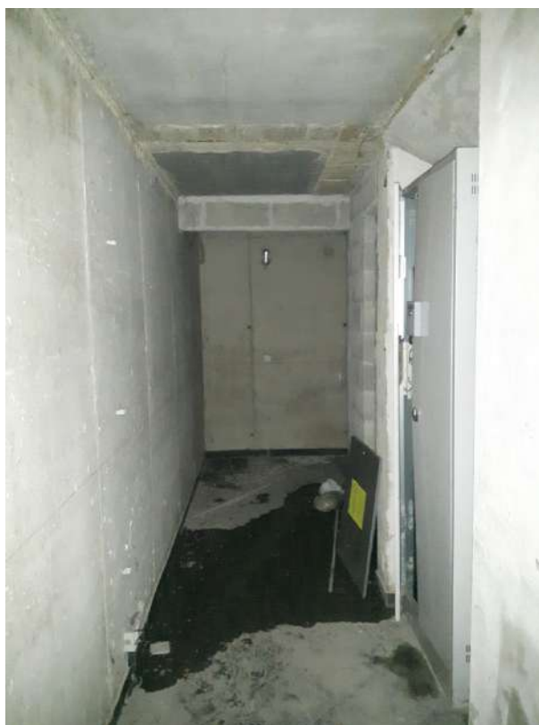
PIANO INTERRATO – Locali Tecnici
