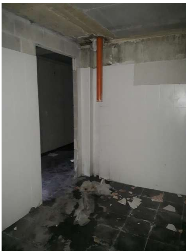
PIANO INTERRATO – Locali Tecnici
