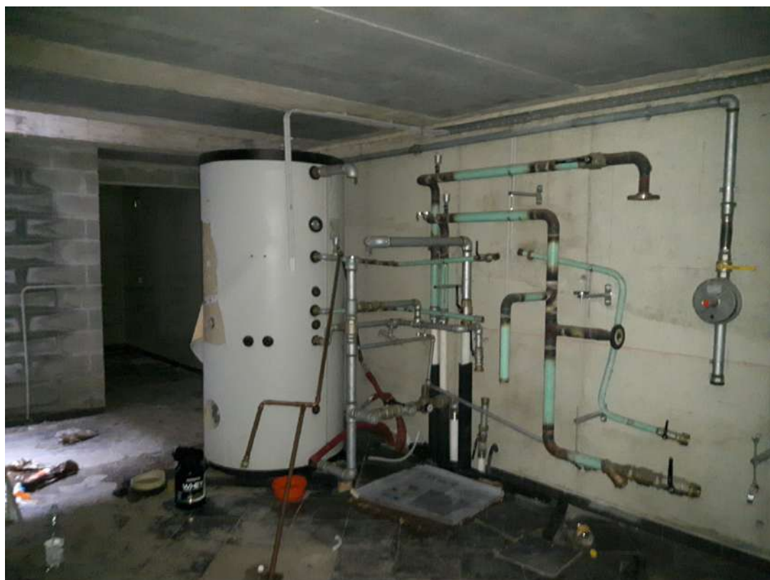
PIANO INTERRATO – Locali Tecnici
