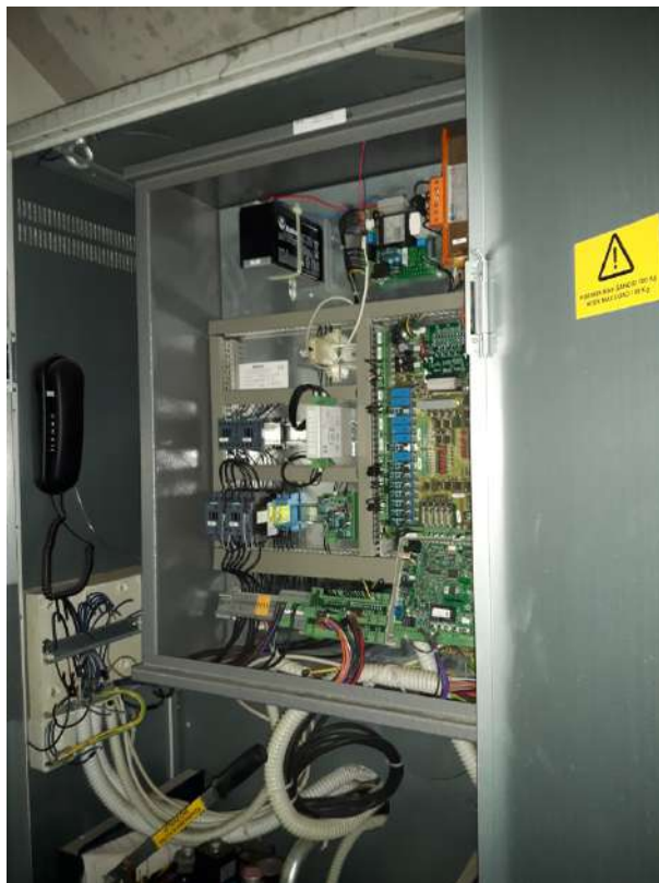
PIANO INTERRATO – Locali Tecnici
