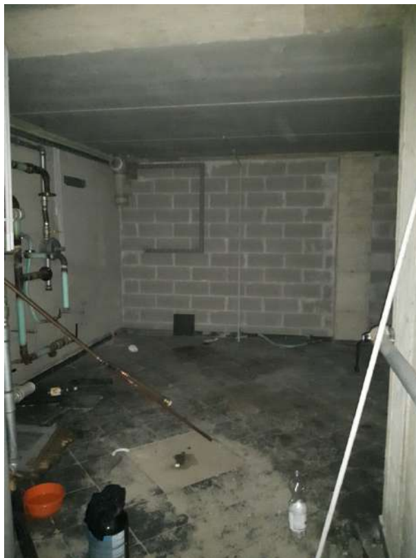
PIANO INTERRATO – Locali Tecnici
