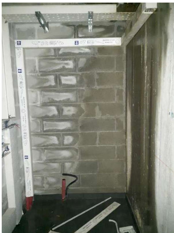
PIANO INTERRATO – Locali Tecnici
