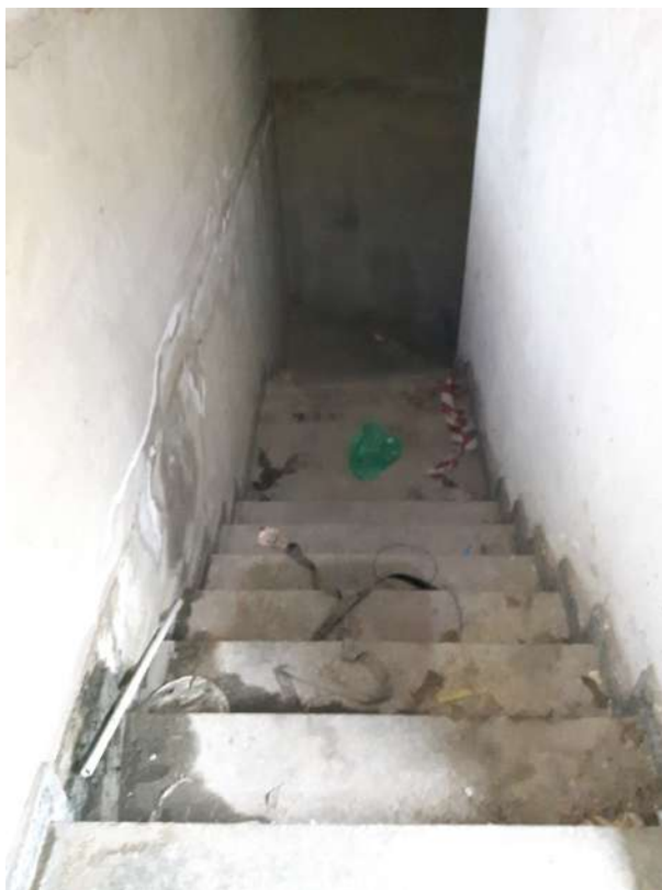
PIANO INTERRATO – Locali Tecnici
