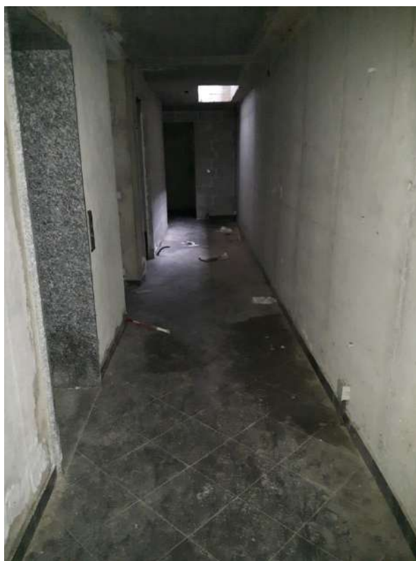
PIANO INTERRATO – Locali Tecnici
