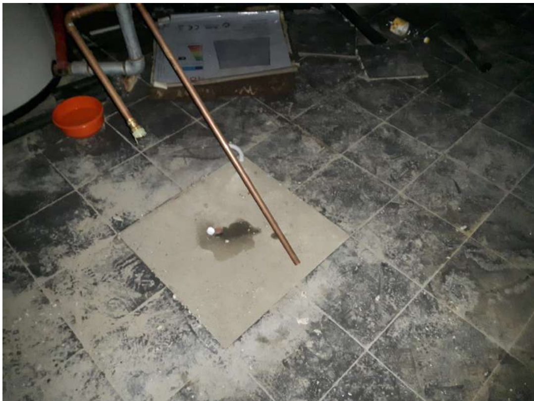
PIANO INTERRATO – Locali Tecnici
