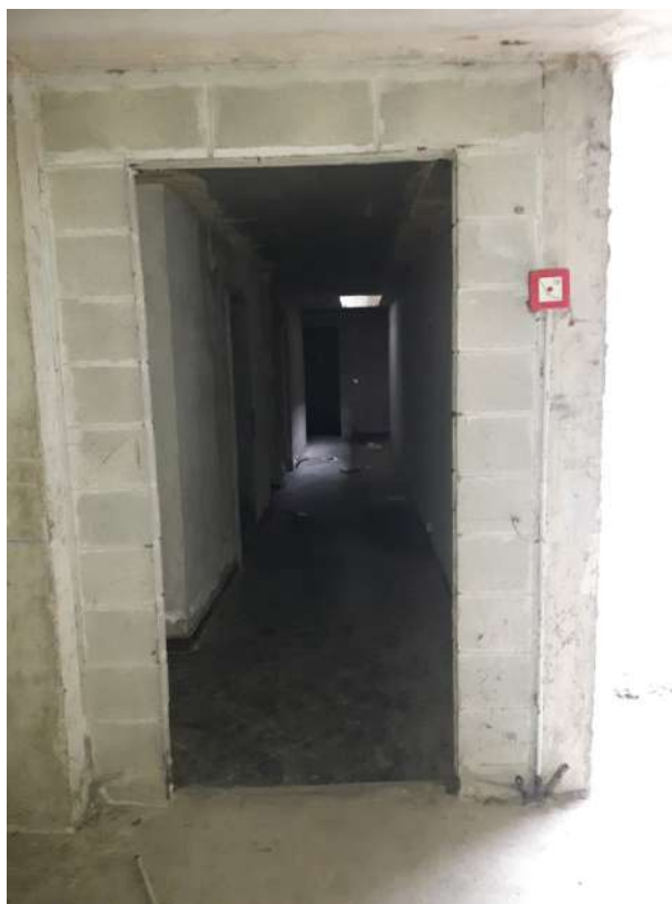
PIANO INTERRATO – Locali Tecnici
