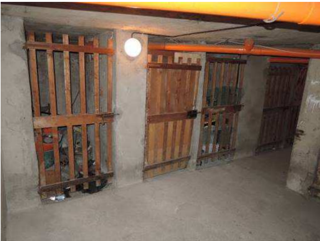
Spazi comuni al piano cantinato ove non è stato possibile individuare la cantina di pertinenza
