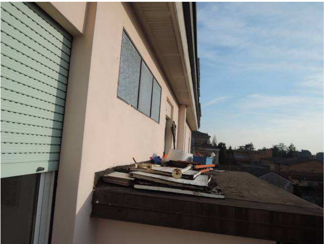
Balcone camera – materiali accumulati sul torrino scala comune
