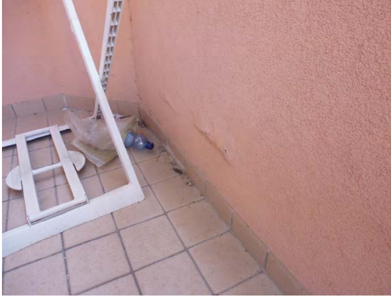
Foto 22 – risalita umidità su muretti terrazza
