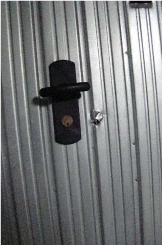
7. Dettaglio del danno alla basculante.
