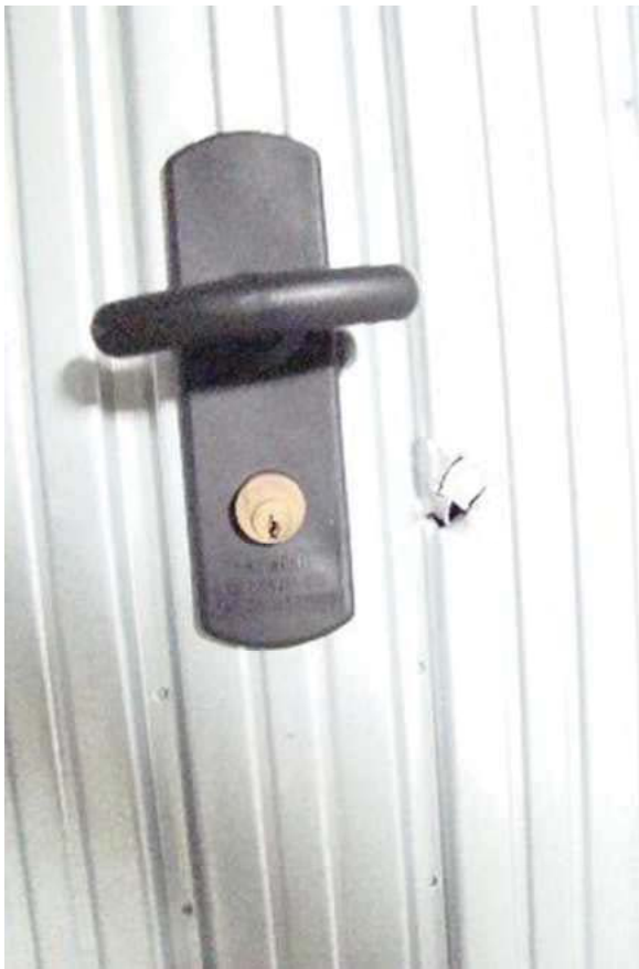
4. Dettaglio del danno alla basculante.
