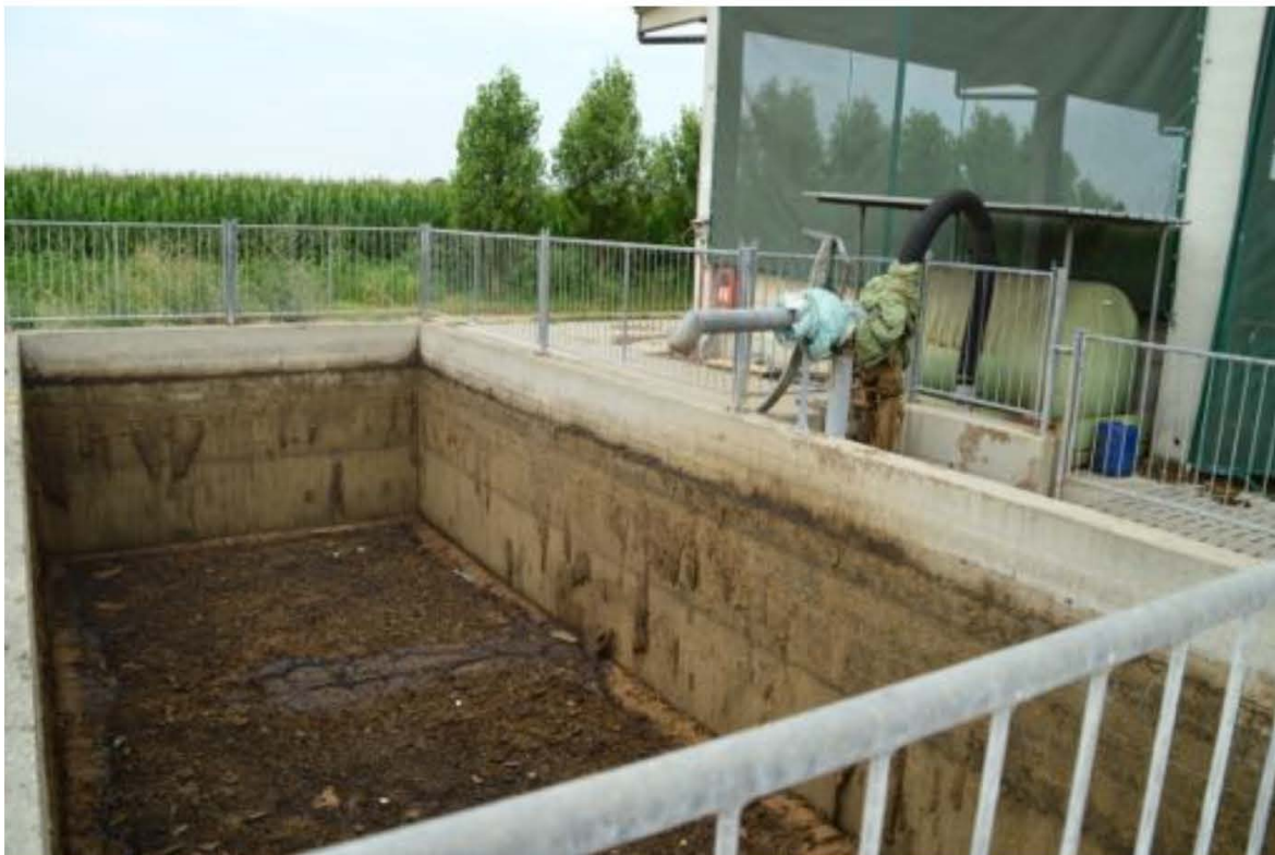
Foto 11,12 – vasche di decantazione
