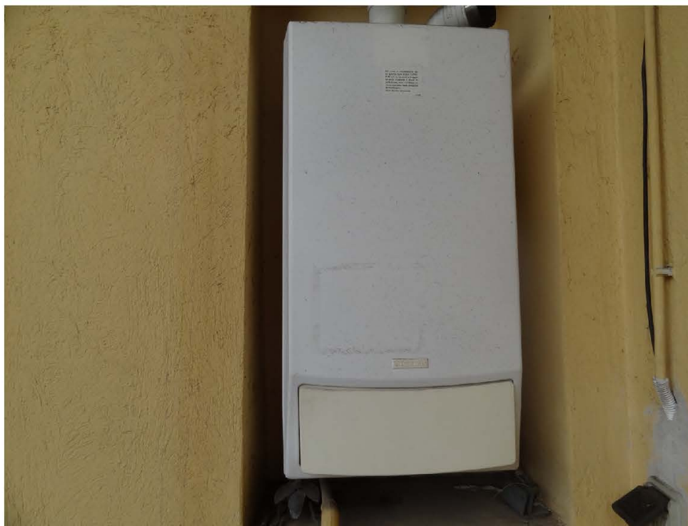
Foto esterna – dettaglio caldaia
