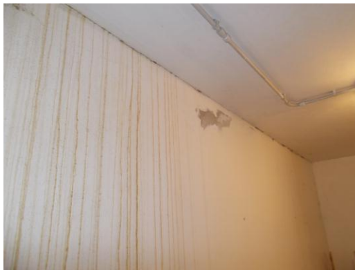
35. Segni di infiltrazioni d'acqua sulla parete della cantina
