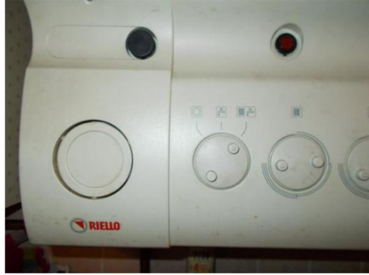
32. Particolare della caldaia per riscaldamento autonomo ed acqua calda sanitaria
